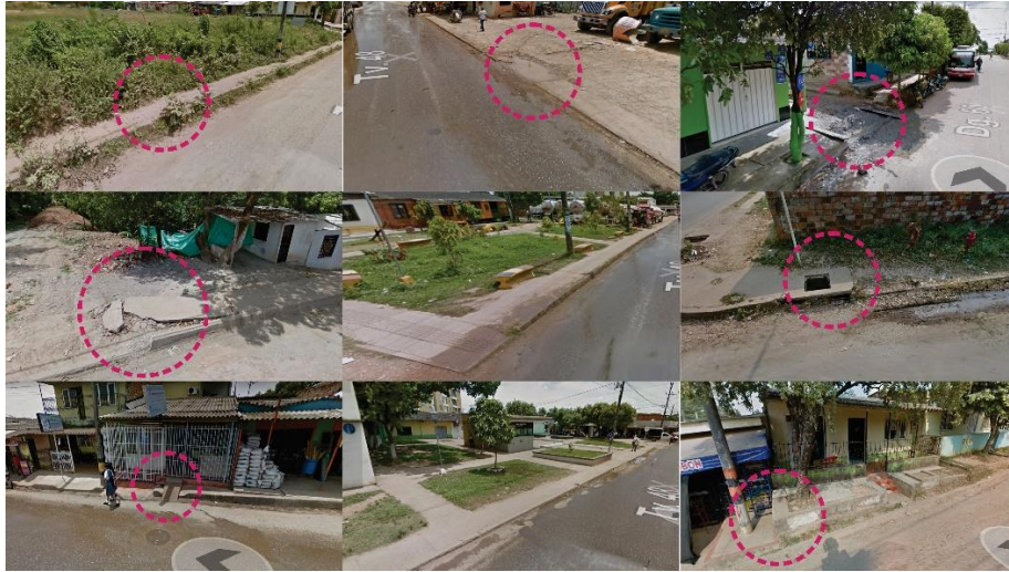
Figura 38. Estado de los andenes
