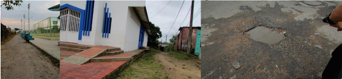
Figura 36. Estado de las vías, comuna 6. Barrancabermeja
