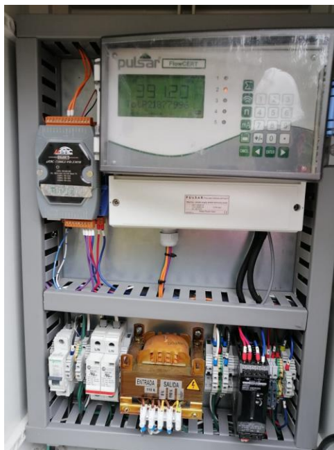
Img 14. Controlador indicador para la medición de flujo estructura de entrada. Fuente: Autor
