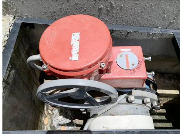
Img 11. Vista principal Electroválvula de Salida desde la estructura de entrada hacia el módulo dos Fuente: Autor
