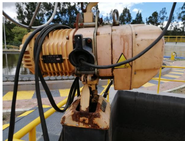
Img 12. Polipasto ubicado en el tanque de lodos del módulo 3. Fuente: Autor
