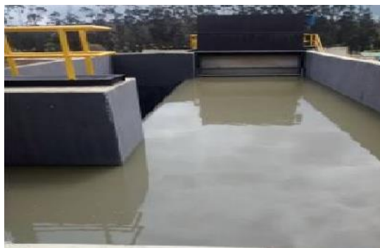
Imagen 1. Estructura de entrada: tanque retención de sólidos grandes o tolda recolectora
