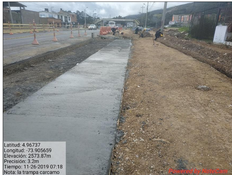
Imagen 40 Cárcamo sector la trampa
