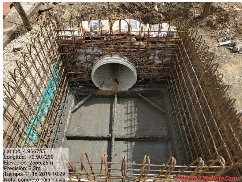
Imagen 33 Piso fundido caja de inspección sector la trampa
