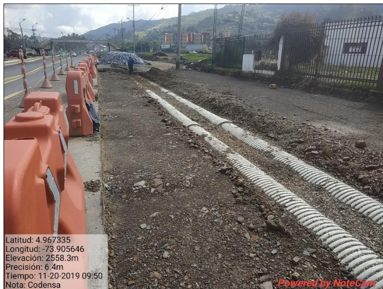
Imagen 39 Tubería superficial sector la trampa
