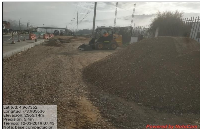
Imagen 47 Base granular sector la trampa
