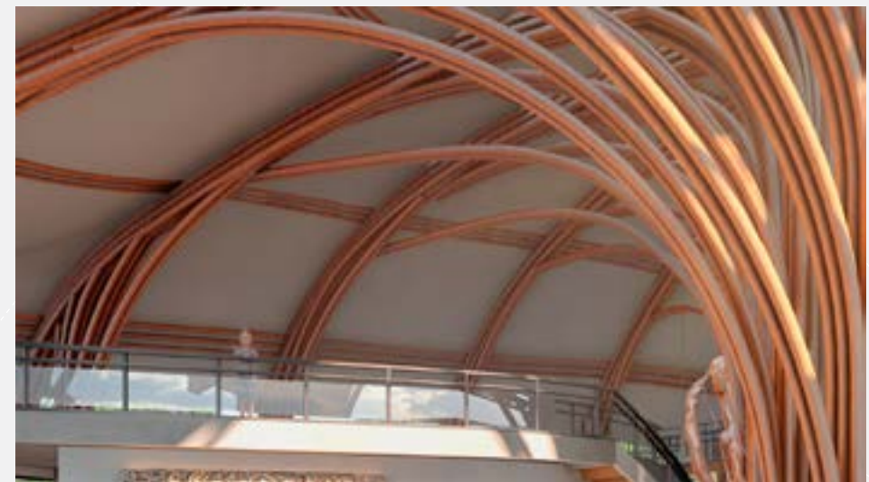
Estructuras en guadua que permiten el juego de curvaturas con la cubierta para crear un ambiente de doble altura.
