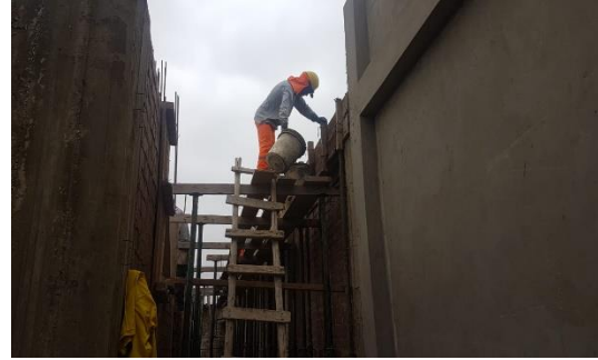
Vaciado de concreto para viga área de cierre cerco perimétrico. Av. San Pedro.
