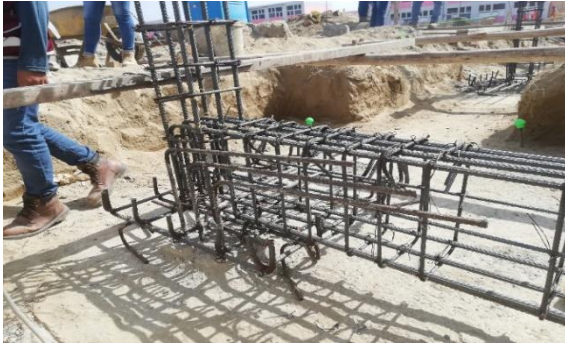
Acero estructural de refuerzo f_y = 4200 \text{ kg/cm}^2 para vigas de cimentación de gradería.
