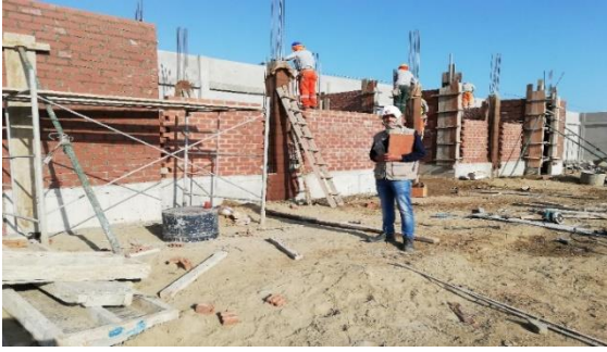
Vaciado de concreto f'c=175 \text{ kg/cm}^2 para columnas de confinamiento, SSHH Vestidores Hombres, Av. San Pedro.
