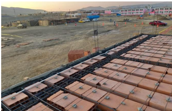
Habitación de acero estructural de refuerzo f_y = 4200 \text{ kg/cm}^2 para losa aligerada SSHH Vestidores Hombres. Av. San Pedro.
