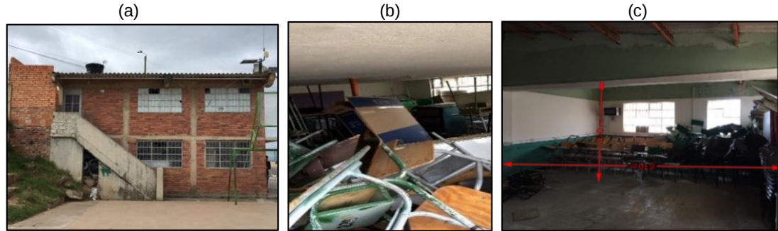
Ilustración 22: Estado del Edificio intervenido- Colegio Gustavo Rojas Pinilla- Sede Club de Leones.
