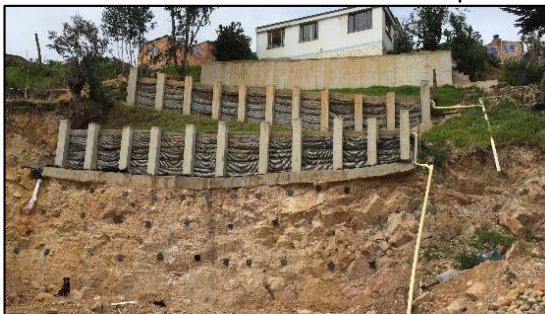
Ilustración 30: Talud del Barrio el Dorado- Inspección visual.
