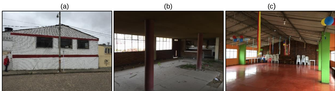
Ilustración 25: Estado de las Instalaciones.
