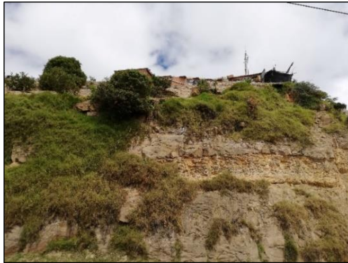
Ilustración 5: Estado inicial del Talud de la María.
