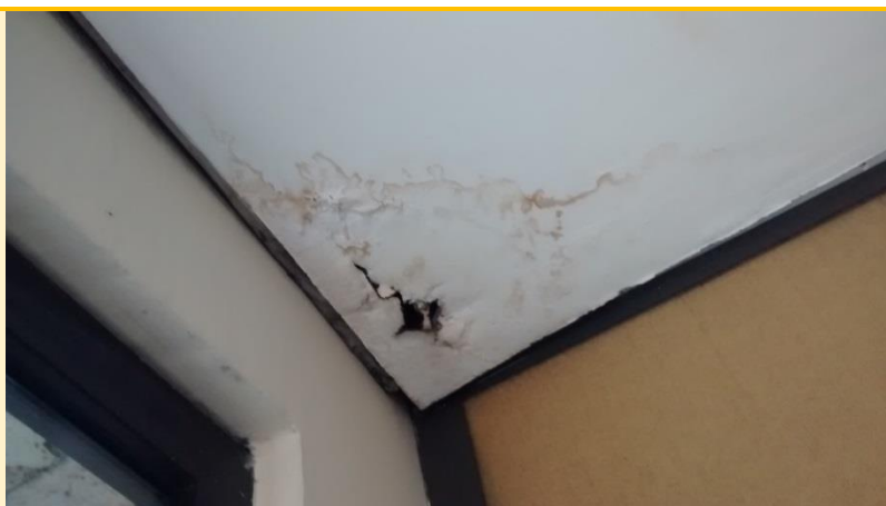
Ilustración 4 Humedad techo séptimo piso Santo Domingo.
