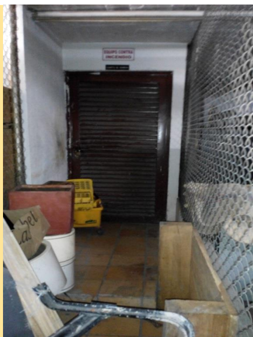
Ilustración 11 Sótano, planta eléctrica
