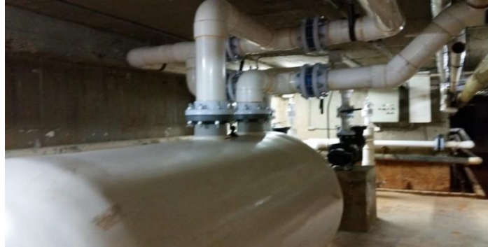
Figura 18. Cuarto de máquinas, Campus San Alberto Magno
