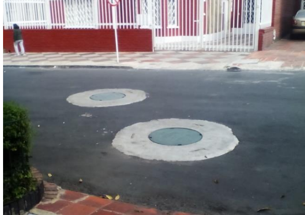
Figura 21. Pozos de inspección de Agua Residual, Edificio Principal.
