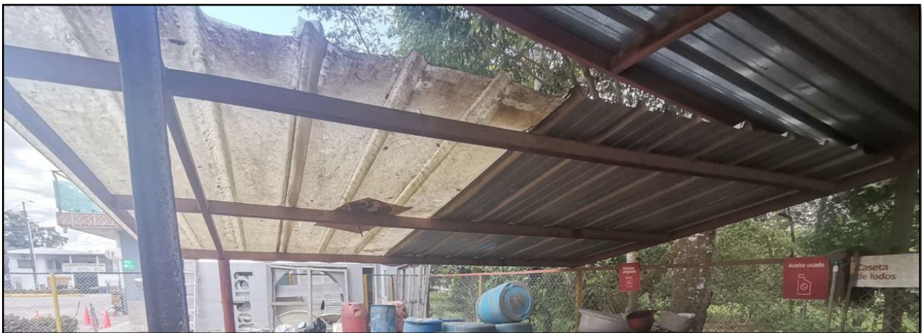
Ilustración 3. Ausencia de instalaciones eléctricas para luz artificial, cableado etc.
