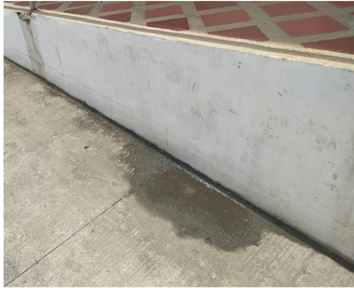
Fotografía 9 Humedad vía pública lesión #5 (Autor)
