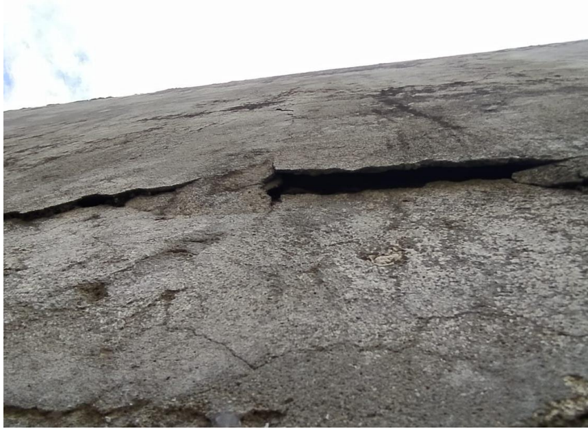
Fotografía 11 Elemento Afectado lesión #6 (Autor)
