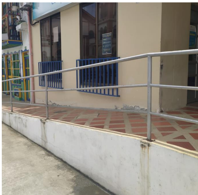
Fotografía 14 Elemento Afectado lesión #8 (Autor)
