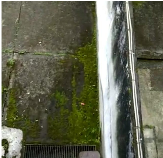
Fotografía 4 Elemento Afectado lesión #2 (Autor)
