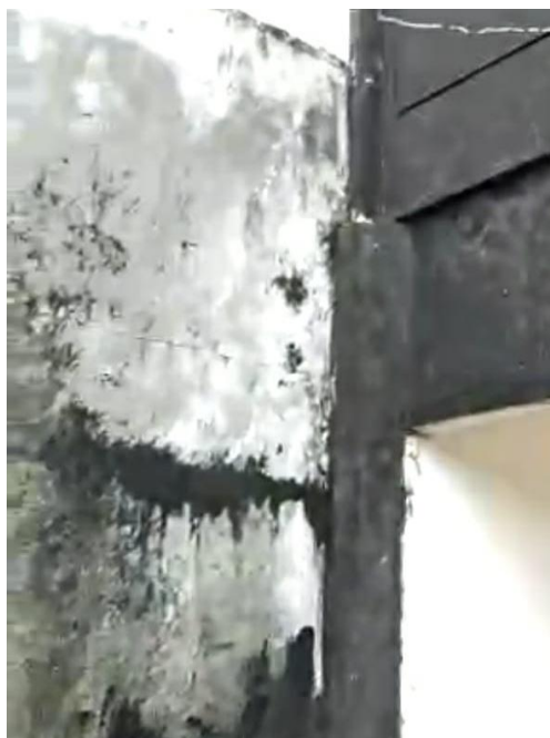
Fotografía 7 Elemento Afectado lesión #4 (Autor)
