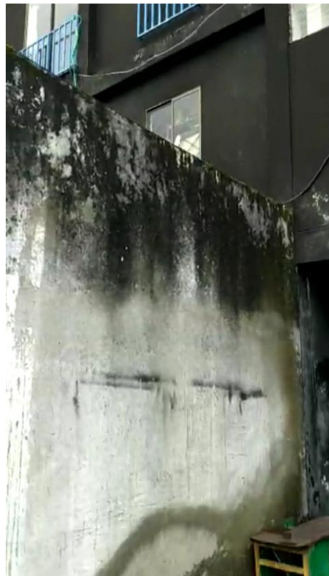
Fotografía 2 Elemento afectado Lesión # 1 (Autor)
