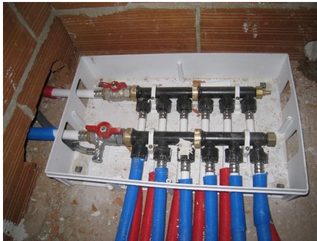
Fotografía 7. Doble distribuidor, entrada y salida de las sondas geotérmicas.
