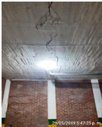
Figura 7. Vista Daños Registrados en Parqueadero. Fuente: Elaboración propia
