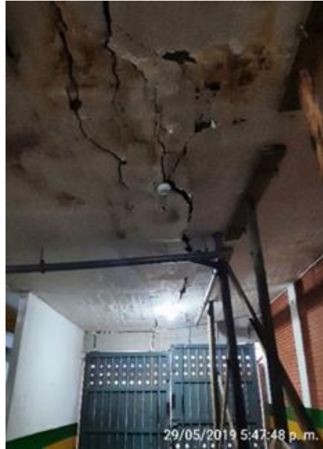
Figura 44. Vista General Fractura Placa de en Zona de Acceso a Parqueadero. Fuente: Elaboración propia
