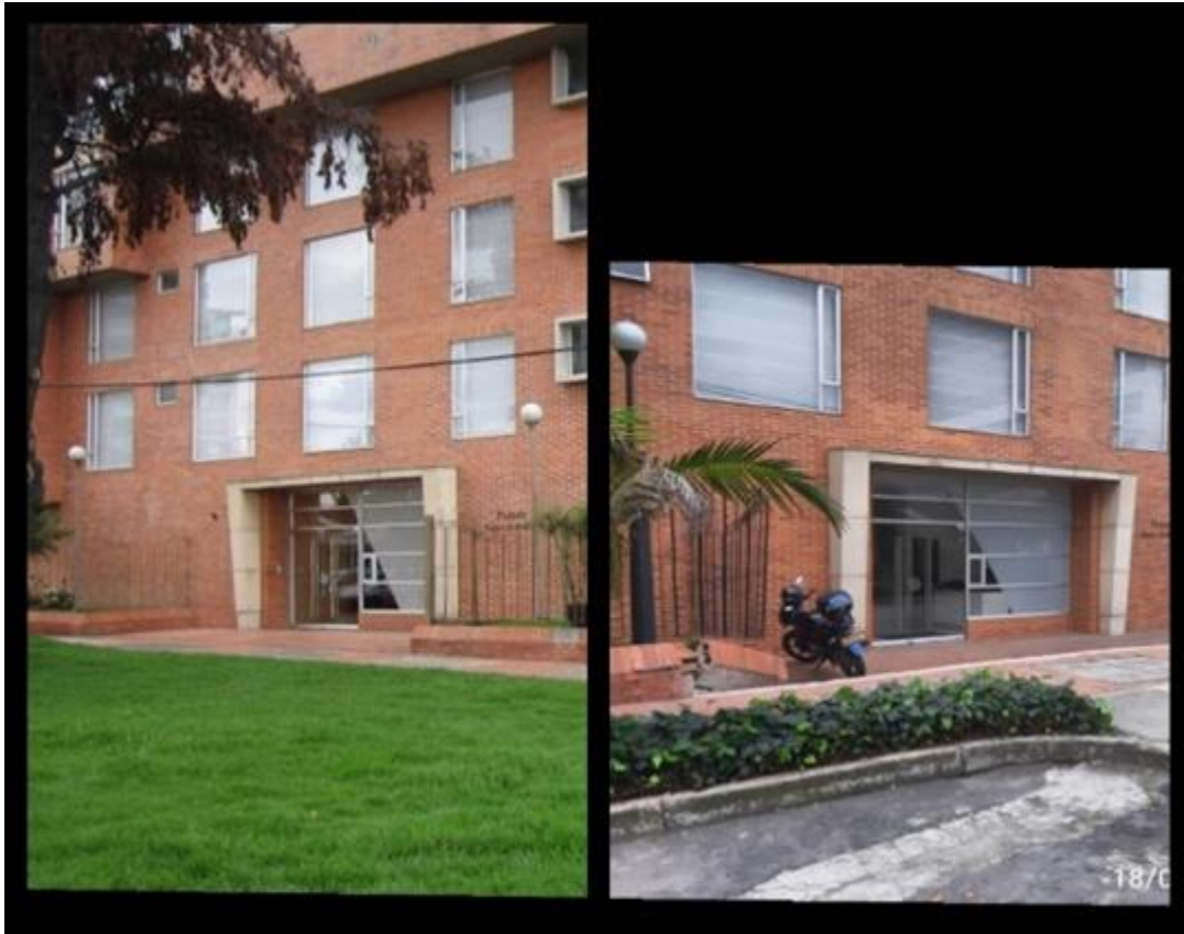
Figura 14. Comparación Asentamiento en Zona de Acceso, Estado en 2015 (Izquierdo) y en 2018 (Derecho).
