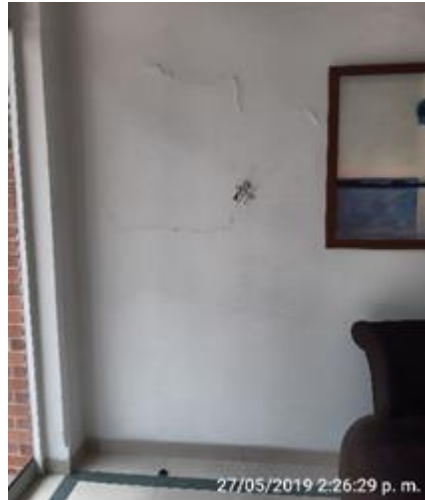
Figura 27. Vista Frontal Daños en Portería. Fuente: elaboración propia
