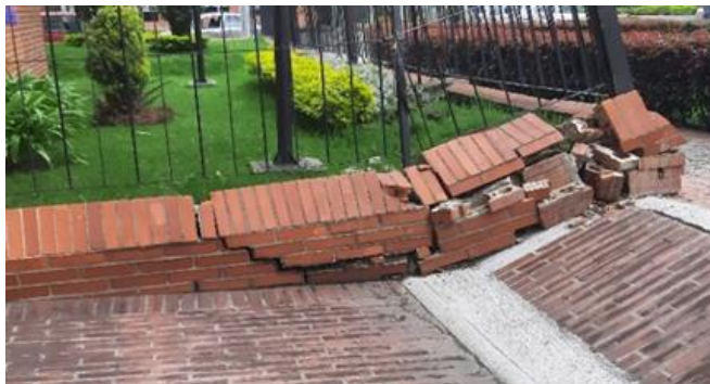
Figura 46. Vista en Detalle Alteración del Nivel en Acceso Principal a Edificio. Daños en Antejardín. Fuente: Evaluación Estructural S.A.S.
