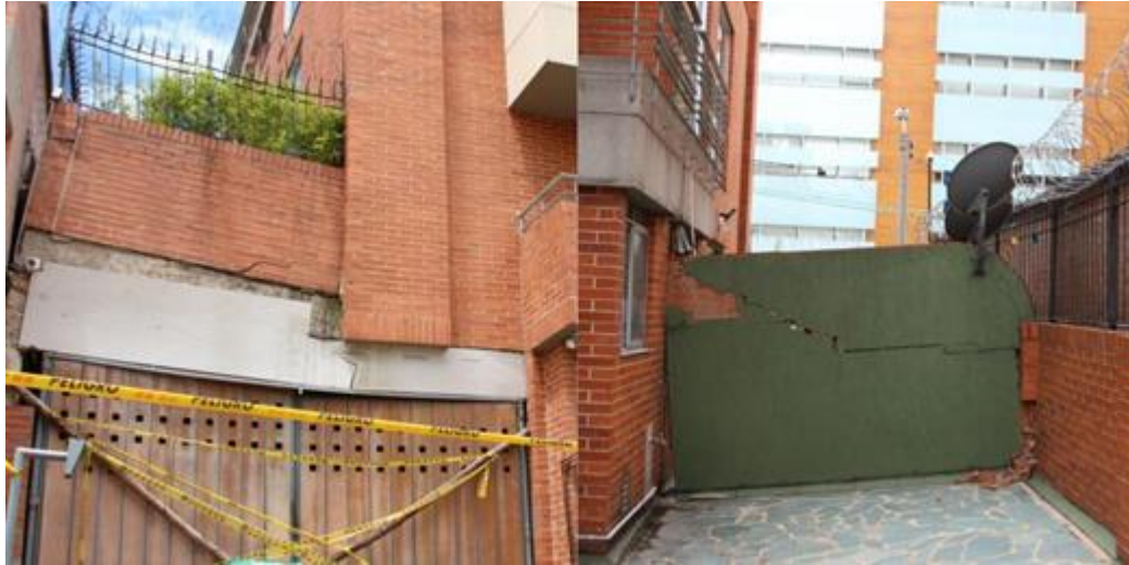
Figura 43. Vista Generales Daños en Costado Norte de Edificio Manglar. Fuente: Elaboración propia
