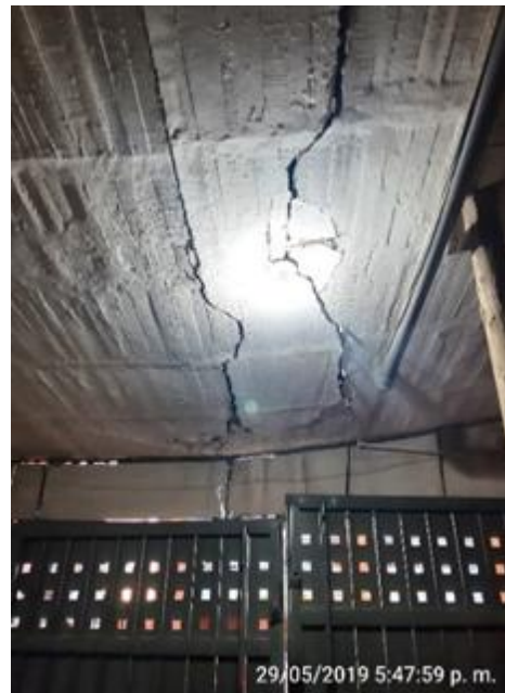
Figura 45. Fractura en Placa, Pérdida de Escuadría en Vano de Puerta de Acceso a Parqueadero. Fuente: Elaboración propia
