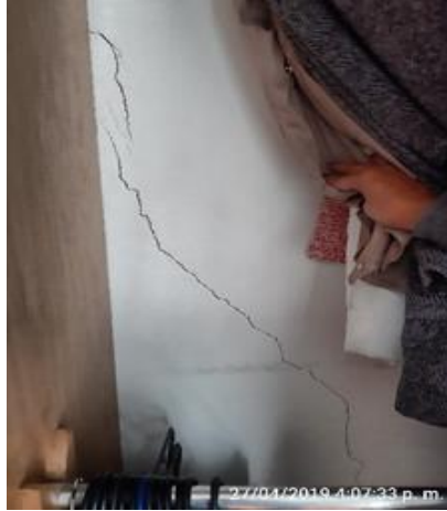
Figura 8. Vista en Detalle Daños Registrados en Zonas Privadas. Fuente: Elaboración propia
