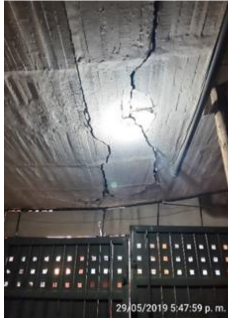
Figura 30. Vista Frontal Daños en Muros y Placa de Terraza. Fuente: Elaboración propia
