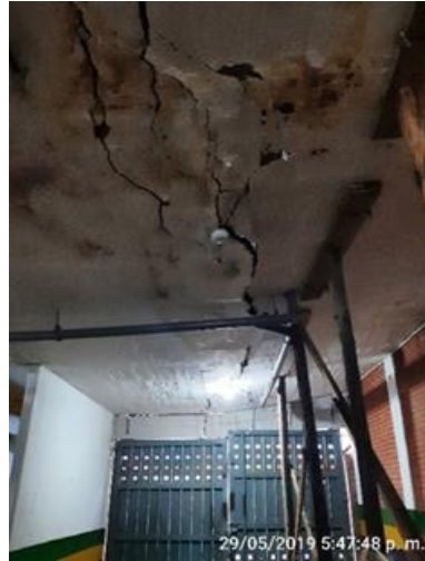
Figura 47. Vista Inferior Fractura en Placa Plataforma Costado Norte. Fuente: Elaboración propia
