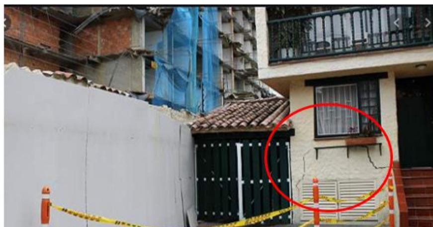
Figura 6. Casas Afectadas por Construcción Edificio de Apartamentos en Cedritos. Fuente: El Tiempo (2015)
