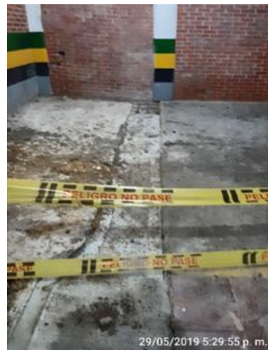
Figura 48. Vista general daños en placa de contrapiso en zona de parqueadero. Fuente: Elaboración propia
