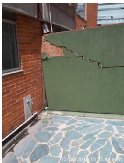
Figura 29. Vista Inferior de Placa, Fracturas y Dislocaciones, Desajuste de Puerta. Fuente: Elaboración propia
