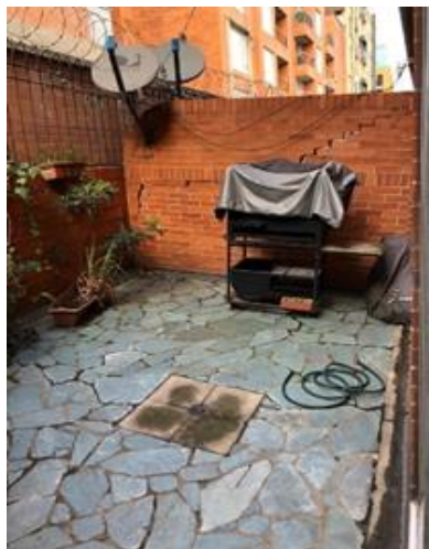
Figura 54. Fractura de Muro Divisorio. Fuente: Elaboración propia
