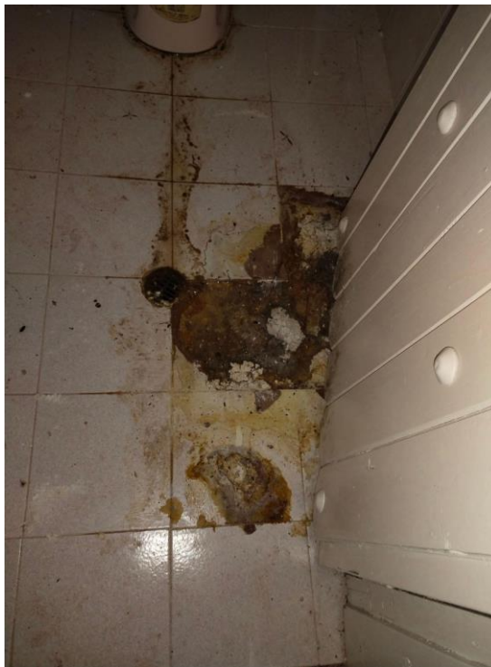
Figura 11 Desgaste de baldosa en laboratorio de química por sustancia desconocida sede central I.E.S.C
