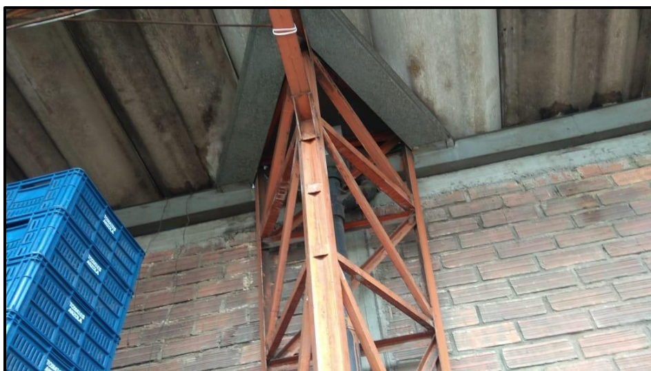
Figura 8. Una de las columnas de estructura metálica en las bodegas de Corabastos. Fuente Propia
