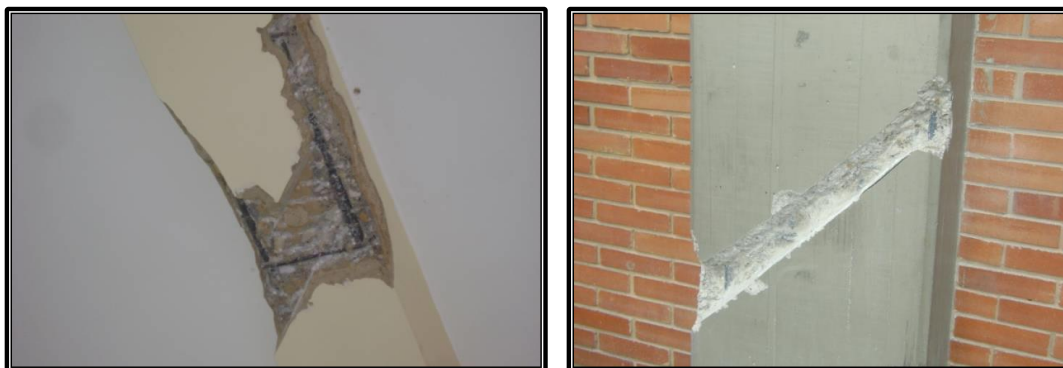
Figura 14. Regatas en vigas y en columnas. Imágenes de Referencia. Fuente Propia
