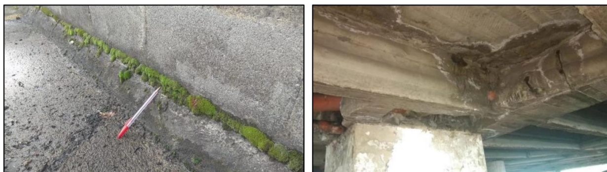
Figura 12. Principales Patologías en edificio de parqueaderos. Fuente propia
