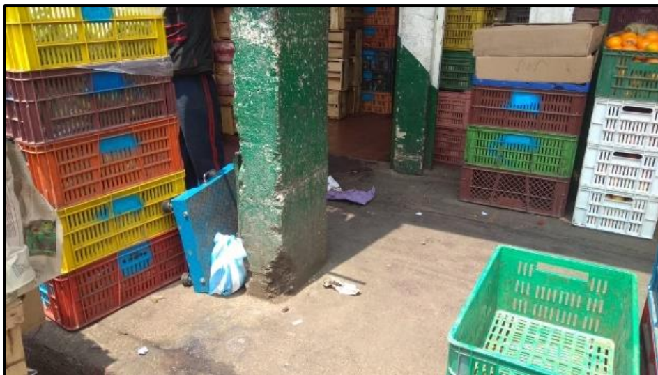
Figura 7. Una de las columnas de los pórticos en concreto en las bodegas de Corabastos. Fuente Propia
