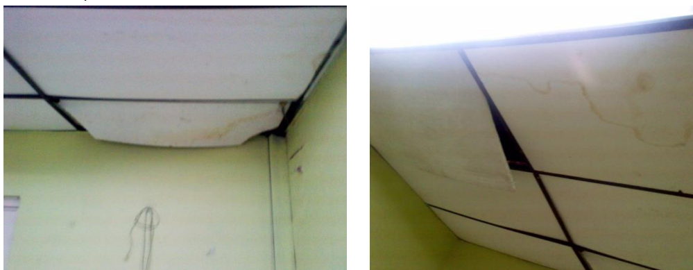
Figura 12. Estado del cielo raso en la oficina de presupuesto de la Alcaldía de San Alberto, Cesar.
