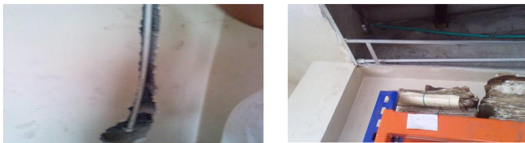
Figura 14. Apreciación de los cielo raso en la tesorería de la Alcaldía de San Alberto, Cesar
