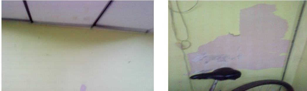
Figura 13. Apreciación de los cielo raso y las paredes de la oficina de presupuesto en la Alcaldía de San Alberto, Cesar
