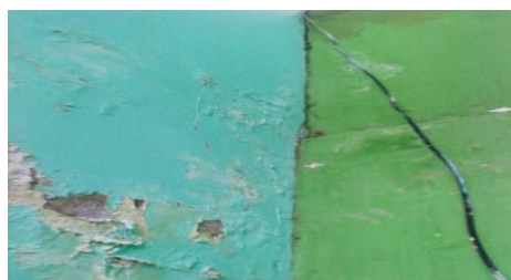
Figura 5. Apreciación de la humedad junto a la escalera en la alcaldía de San Alberto, Cesar.
