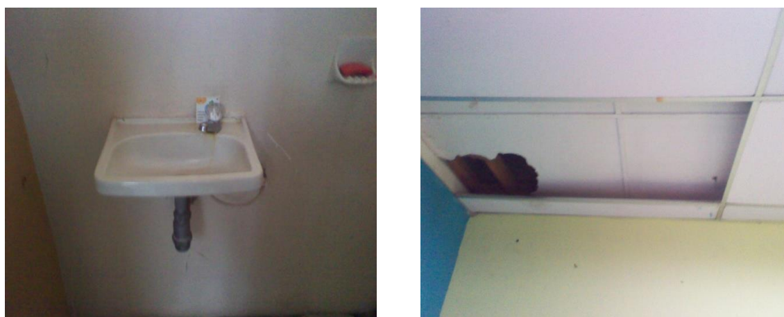
Figura 4. Fotografías del baño en la tesorería de San Alberto, Cesar
