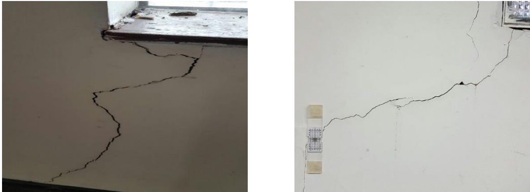
Figura 66. Agrietamiento pasante en los muros e instalación de regletas.
