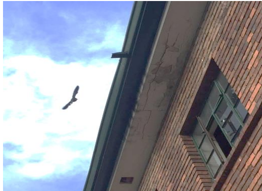
Figura 50. Deterioro por humedad en cielo raso cubierta, ataque por aves.
