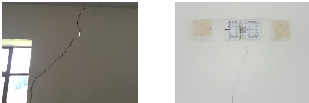
Figura 65. Agrietamiento pasante en los muros e instalación de regletas.
