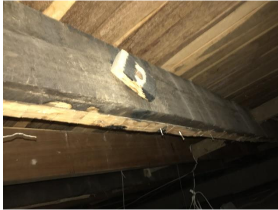
Figura 53. Estado general vigas de soporte entrepiso.
