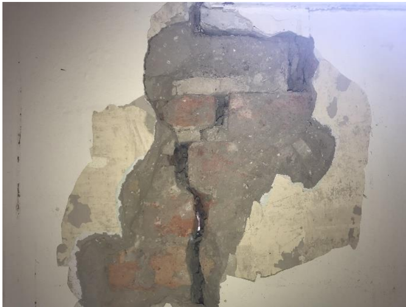
Figura 64. Fractura de la mampostería, fachada posterior.
