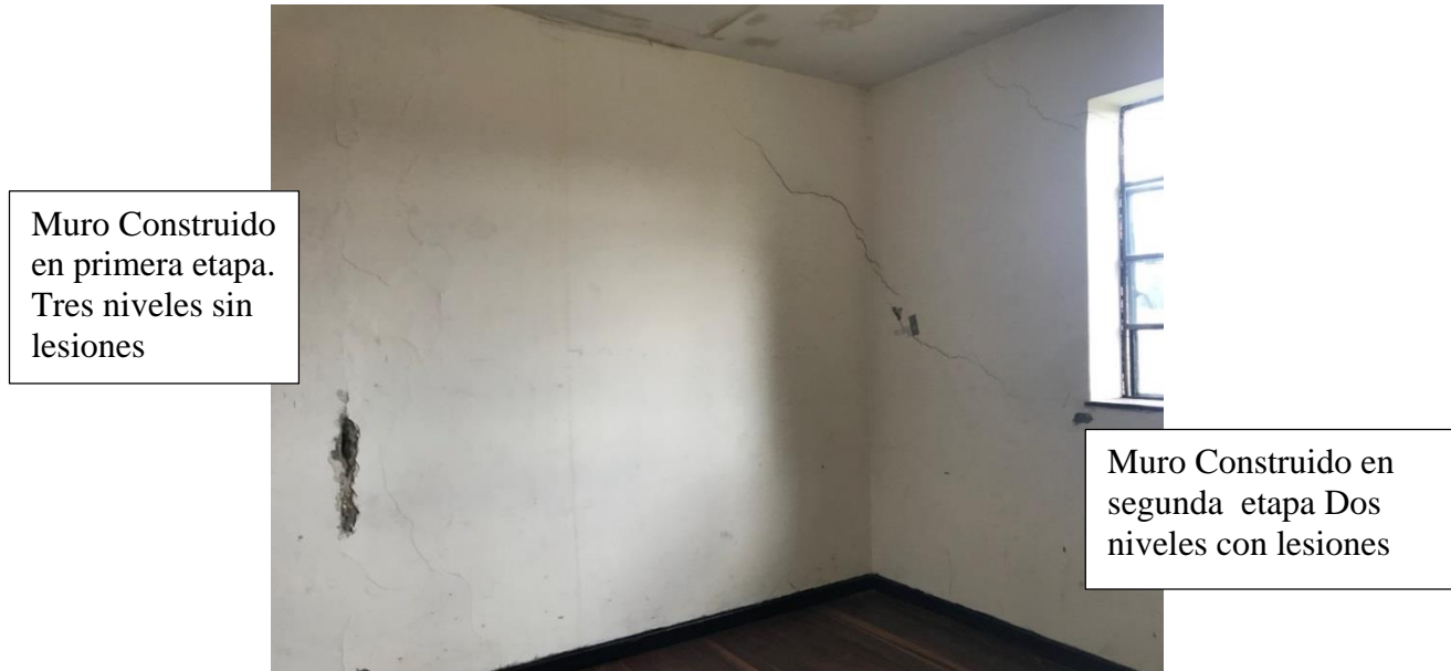
Figura 107. Lesiones y dilatación vertical existente
