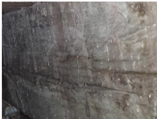
Figura 51. Deterioro y agrietamiento longitudinal en vigas de entrepiso.
