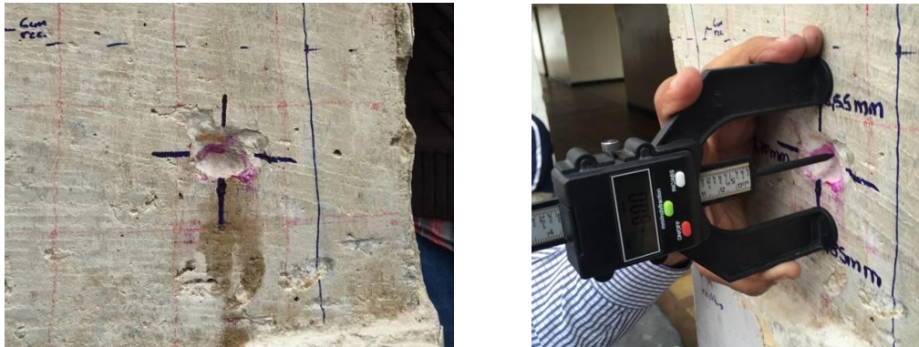
Figura 37. Determinación de la profundidad de carbonatación método 4 puntos.
