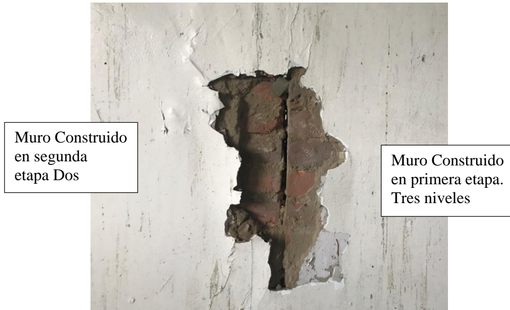
Figura 105. Dilatación entre mampostería se aprecia junta sin trabe de mampostería
