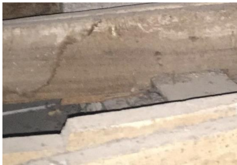
Figura 48. Deterioro por humedad sin pérdida de integridad.
