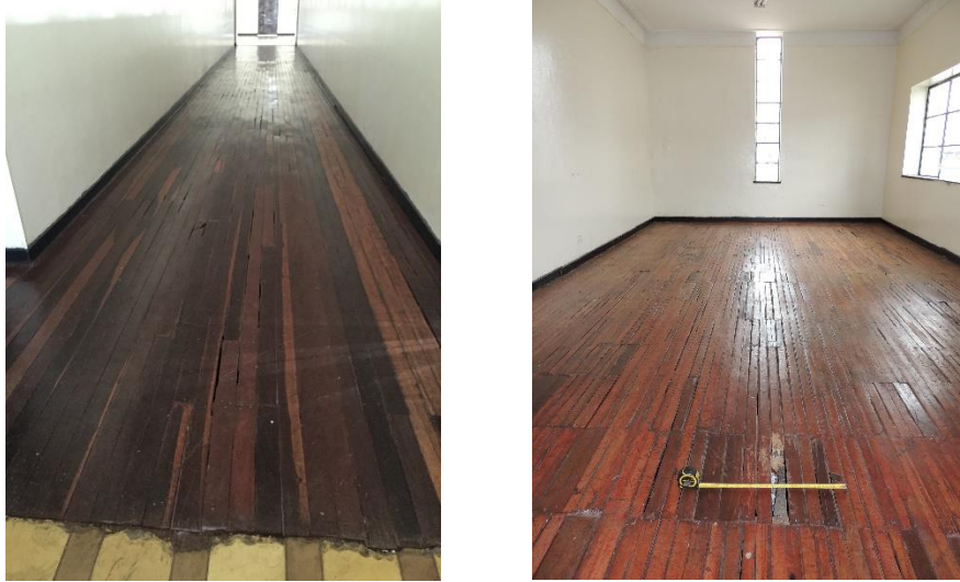
Figura 63. Estado general de los pisos de madera de circulaciones y alojamiento.
