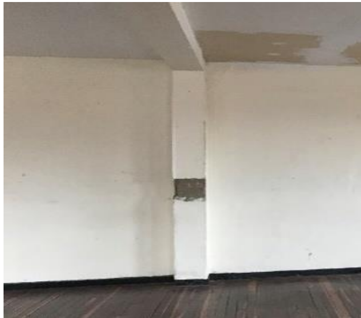
Figura 117. Machones salientes existentes en módulos a intervenir
