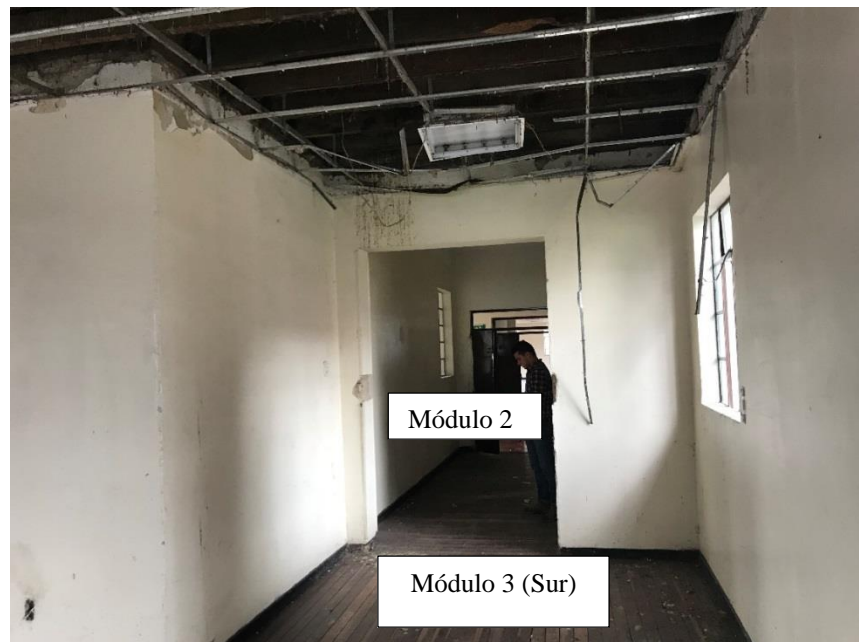
Figura 110. Dilatación de puerta apertura del vano módulo 3 y módulo 2
