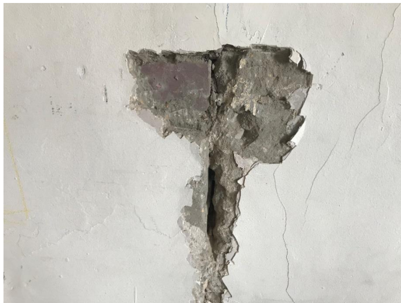
Figura 108. Dilatación entre mampostería se aprecia junta sin trabe de mampostería
