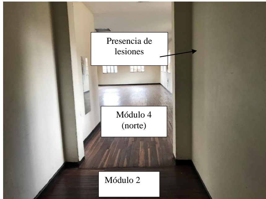
Figura 109. Dilatación Machones en dilatación de puerta apertura del vano
