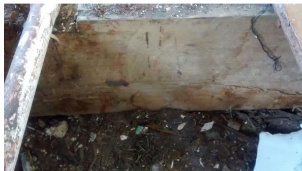
Figura 49. Deterioro por humedad sin pérdida de integridad.
