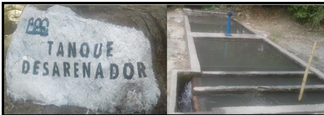
Figura 5: Tanque Desarenador - Río La Paila.
