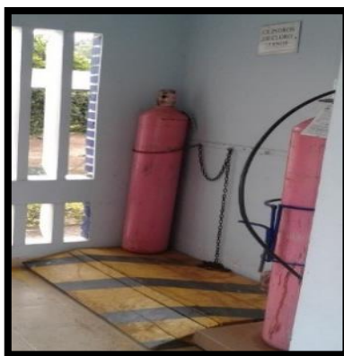
Figura 12: Cuarto de Cloración.
