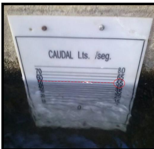
Figura 17: Regla medidora de caudal
