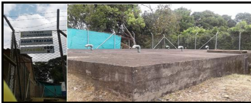
Figura 13: Tanque de Almacenamiento.
