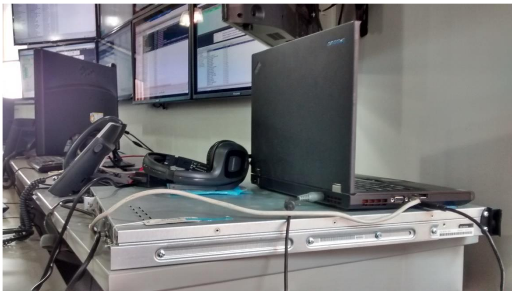
Fig. 12. Conexión PC – Servidor por cable de red
