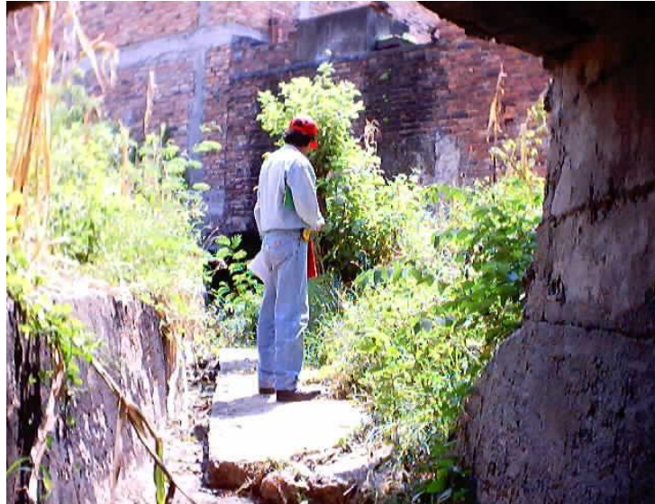
FOTO 2 Muros colapsados (K0+000)
