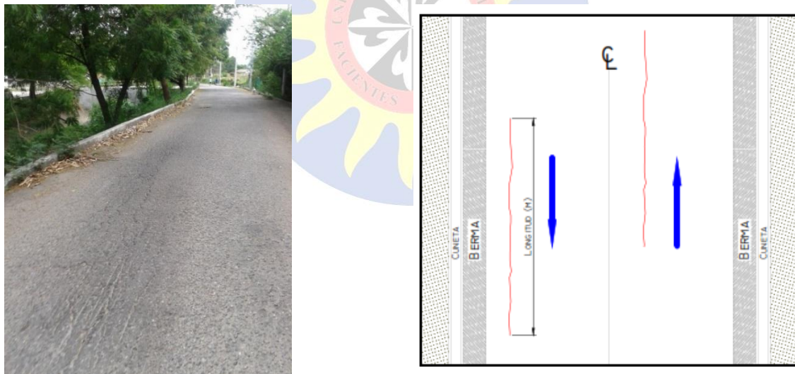
FOTO 7 Fisura longitudinal (FL, Unidad de medida m)
