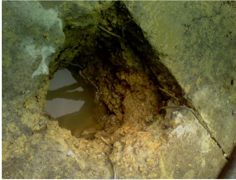
FOTO 15. Afloramiento de agua sondeo 8 y 9, no se encontrándose material de base en la parte superior
