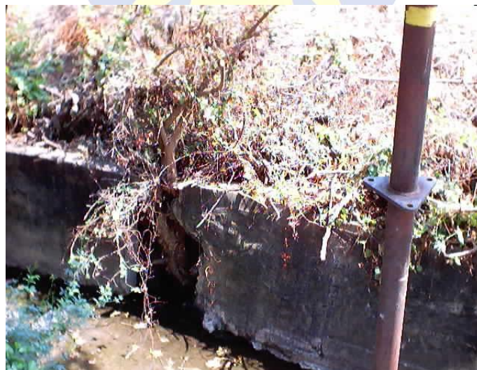
FOTO 3 Socavación en muros fracturados
