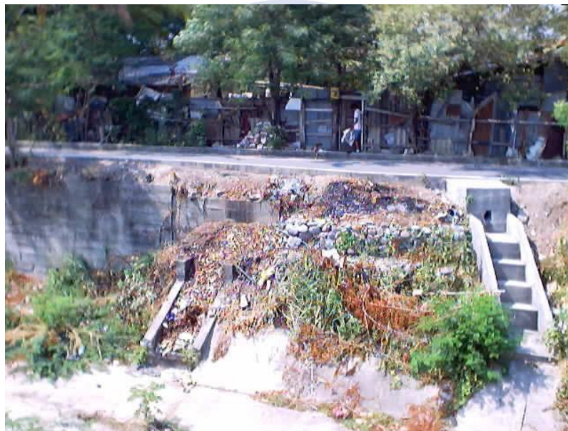
FOTO 6 Acumulación de basuras a lo largo de la vía
