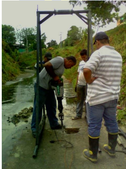
FOTO 14. Instalación de equipos y perforación capa de pavimento, para dar inicio a los ensayos, para determinar el LL, LP, IP, IC, humedad natural, contenido de finos y clasificación
