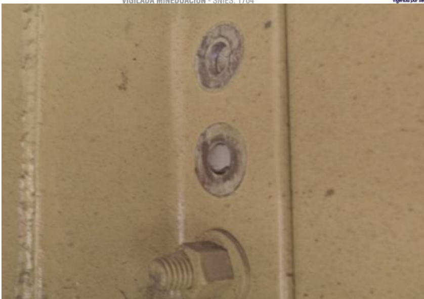
Figura 24. Evidencias rotura de pernos
