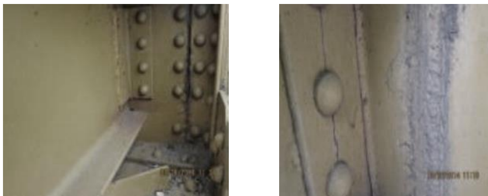
Figura 5. Evidencias del deterioro
