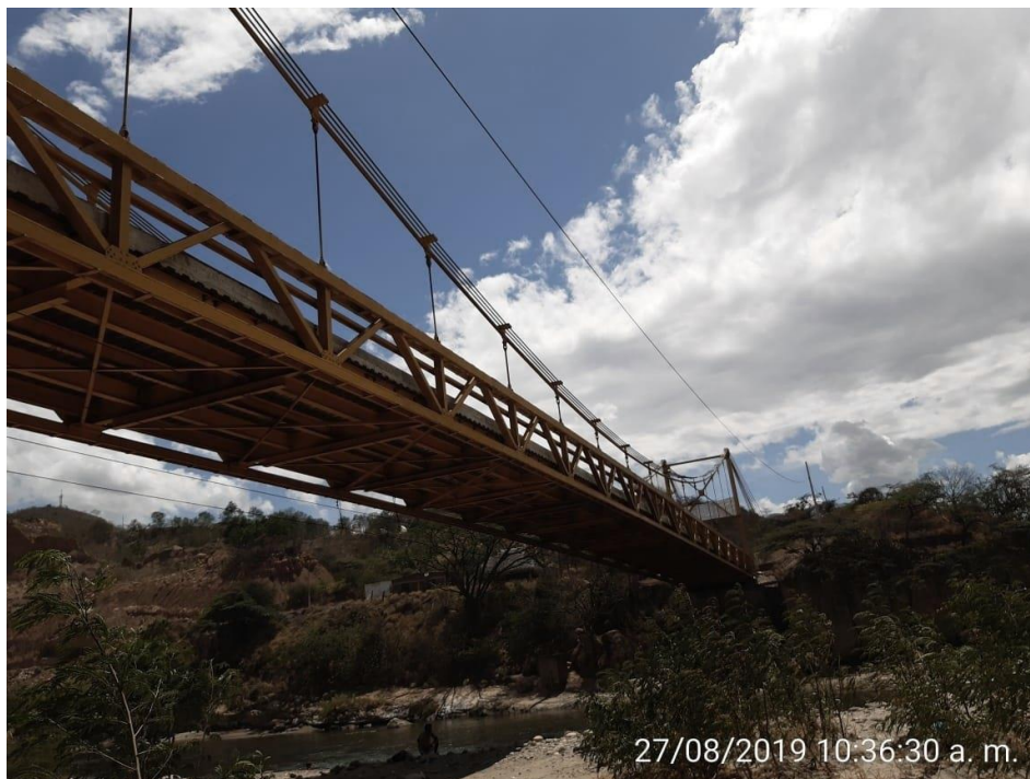
Figura 34. Riostras de vigas laterales
