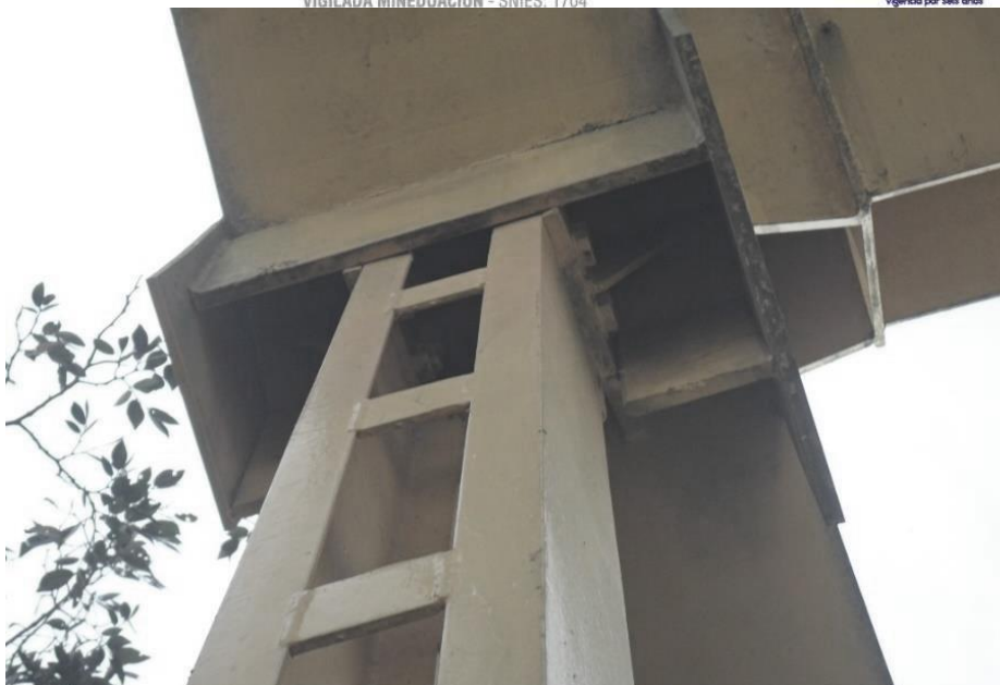
Figura 35. Estado de pendolones
