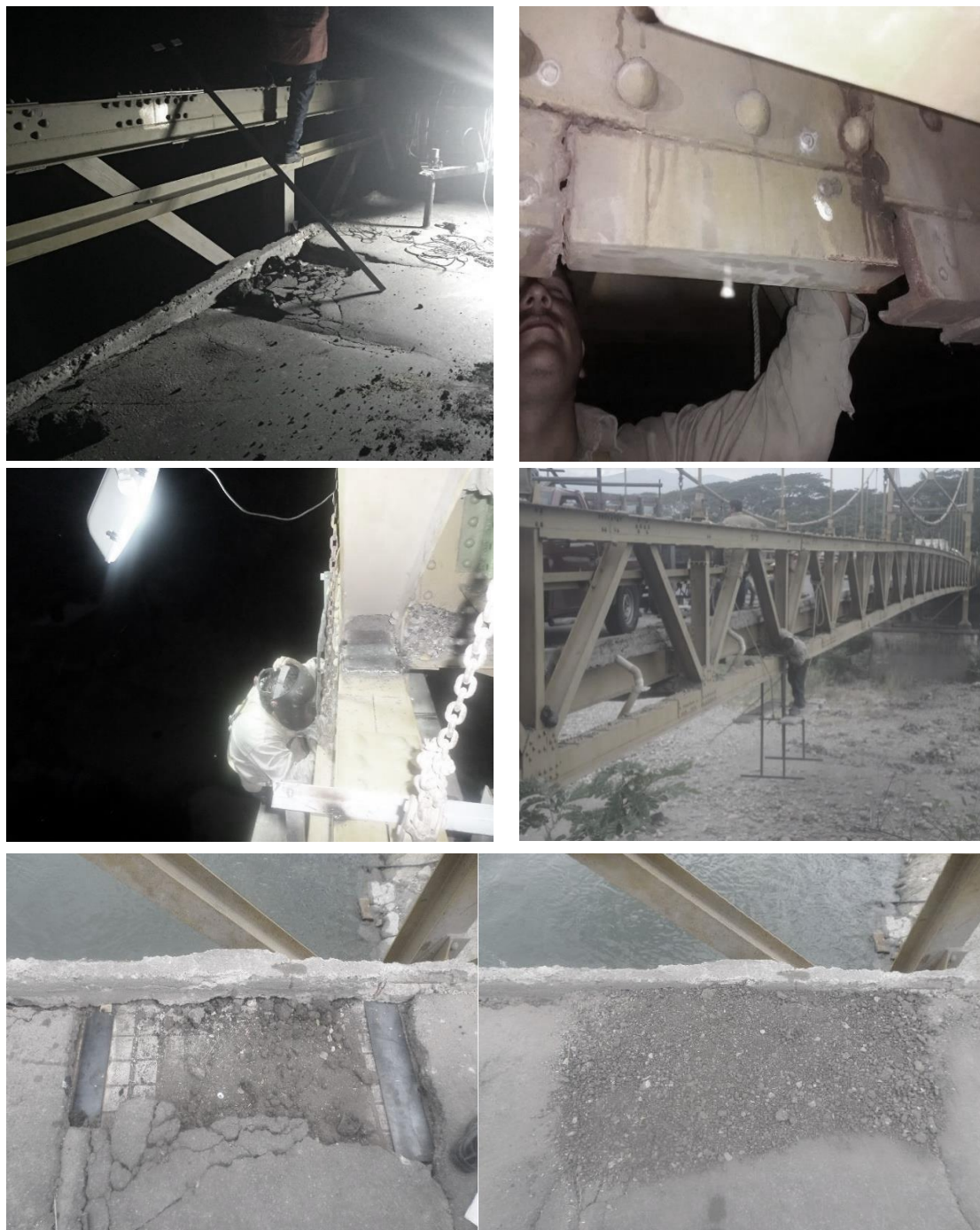
Figura 73. Estado de deterioro
