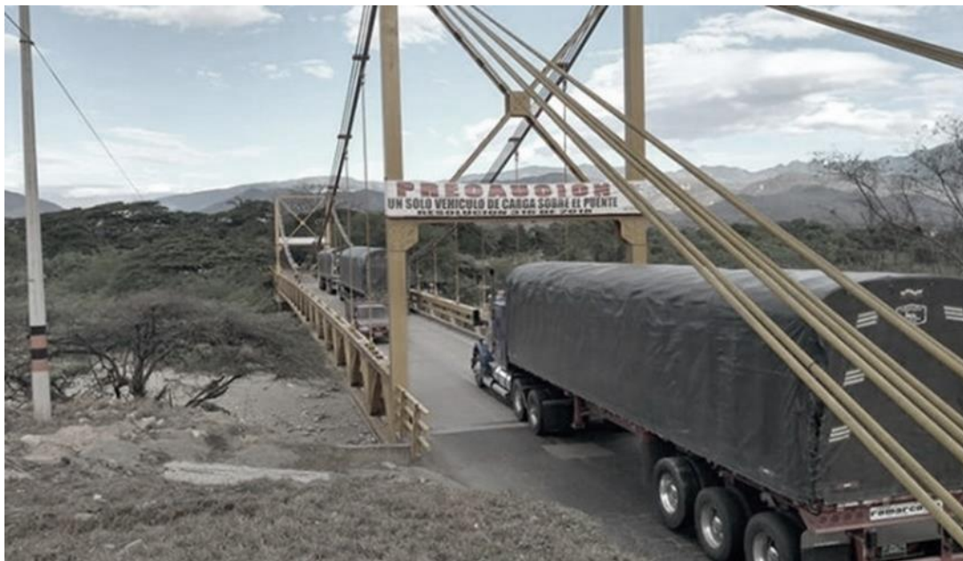
Figura 80. Puente Mariano Ospina con restricción de carga
