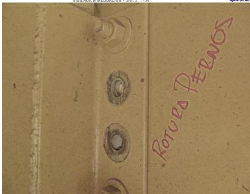
Figura 20. Rotura de perno por cizallamiento, evidencia del corte del elemento sometido a cortante
