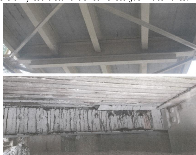
Figura 47. Daños en vigas, largueros y diafragma
