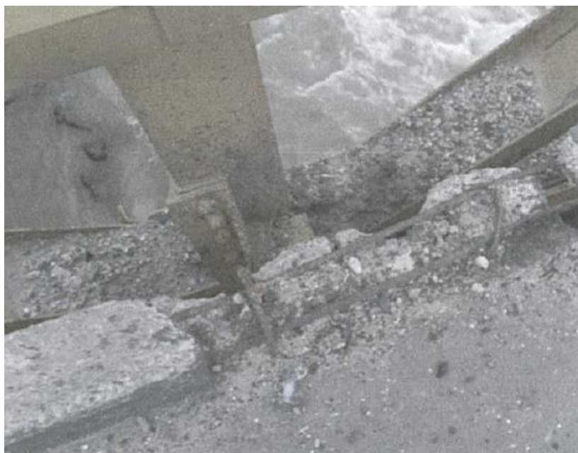
Figura 49. Conexiones de cerchas de rigidez. Obstrucción por acumulación de tierra, basuras y otros materiales.
