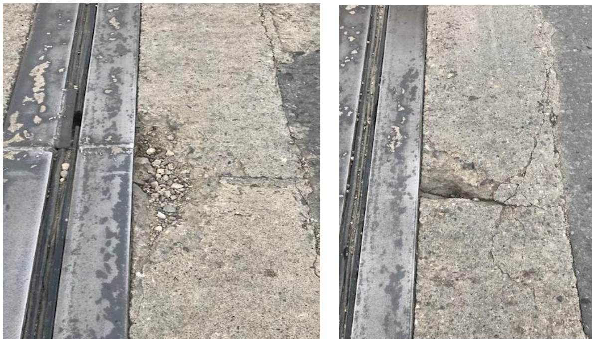
Figura 74. Desprendimiento de material en junta de dilatación junto a la torre del lado Zulia
