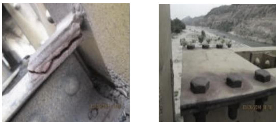
Figura 6. Fisuras y corrosión de piezas
