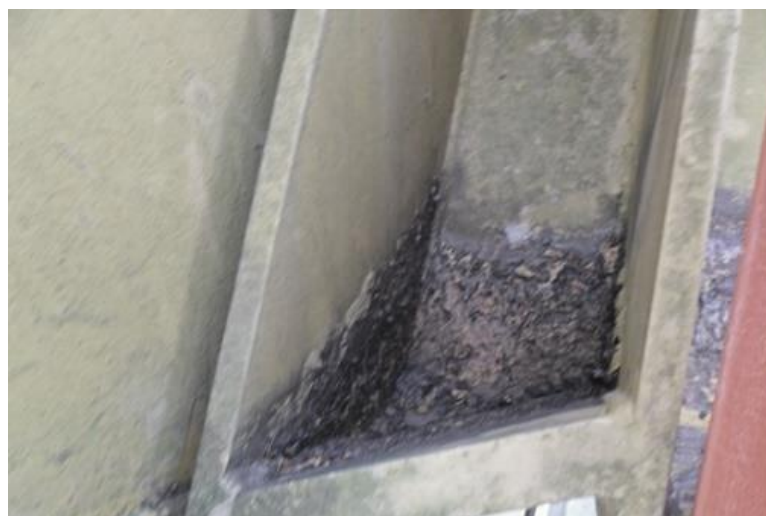
Figura 33. Corrosión en canaletas
