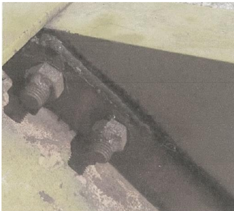
Figura 48. Corrosión de soldaduras y tornillos reemplazando conexiones.
