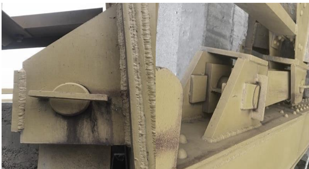
Figura 52. Estado de basculantes
