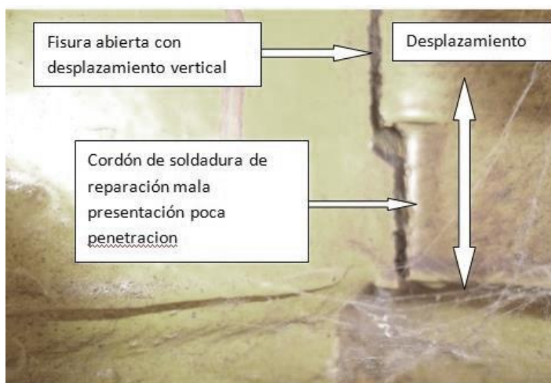
Figura 17. Rotura total abierta en soporte reparado con soldadura
