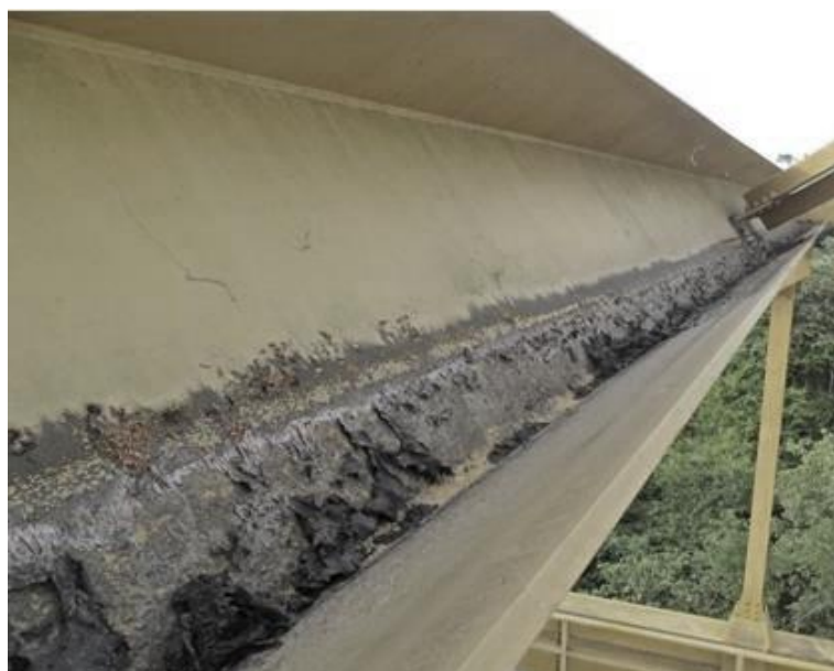
Figura 32. Evidencia deterioro de canaletas
