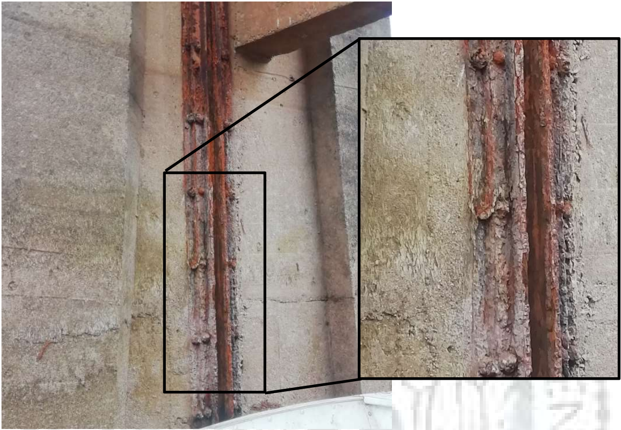
Fotografía. 73. Proceso corrosivo rieles guía compuerta.
