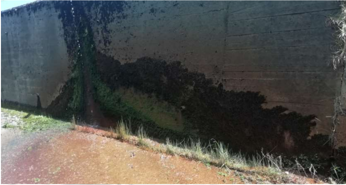
Fotografía. 90. Presencia y afloramiento de musgo sobre el muro lateral del canal. Fuente: Consorcio Embalses CAR, 2020.
