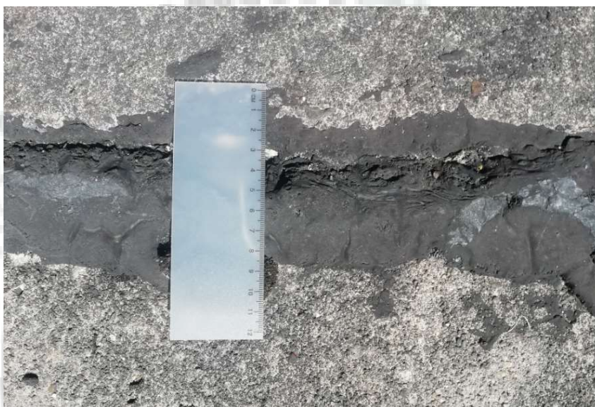
Fotografía. 85. Pérdida y deterioro del material de sello de la junta.
