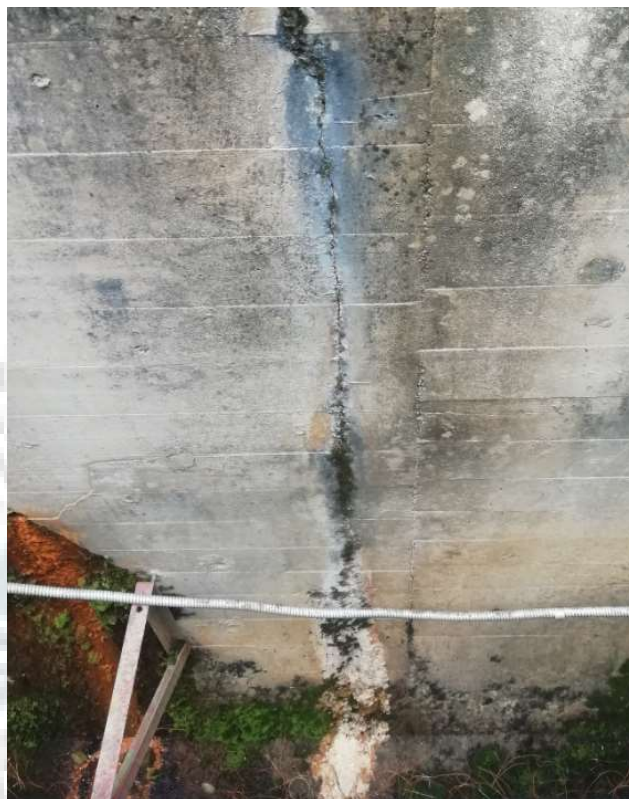
Fotografía. 76. Presencia de eflorescencias junta vertical. Fuente: Consorcio Embalses CAR, 2020.
