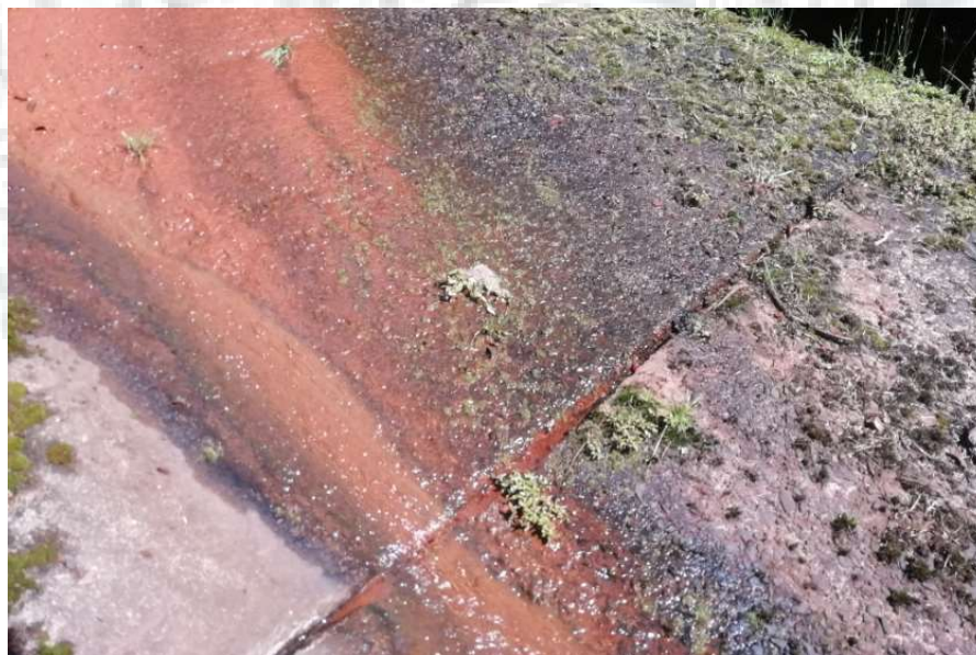
Fotografía. 88. Procesos de infiltración a través de la junta. Fuente: Consorcio Embalses CAR, 2020.
