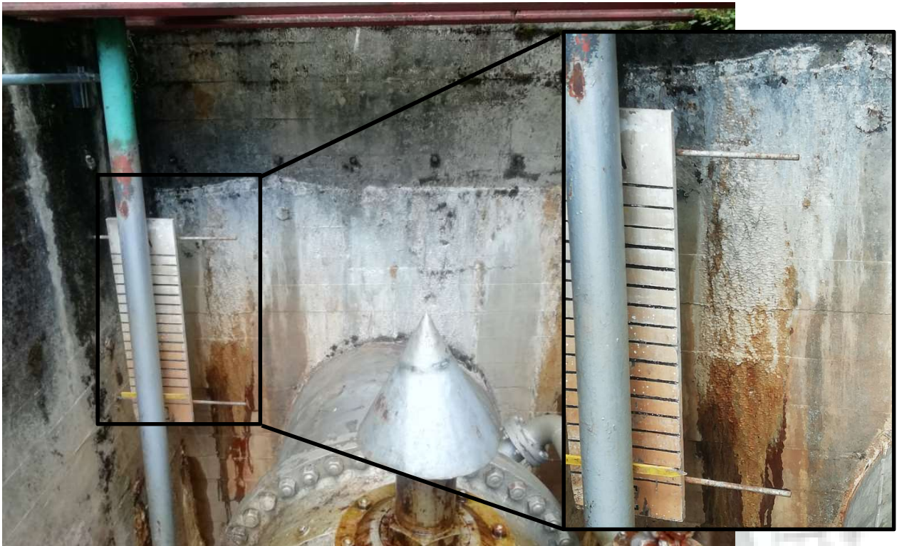
Fotografía. 75. Presencia de eflorescencias en el portal de salida. Fuente: Consorcio Embalses CAR, 2020.
