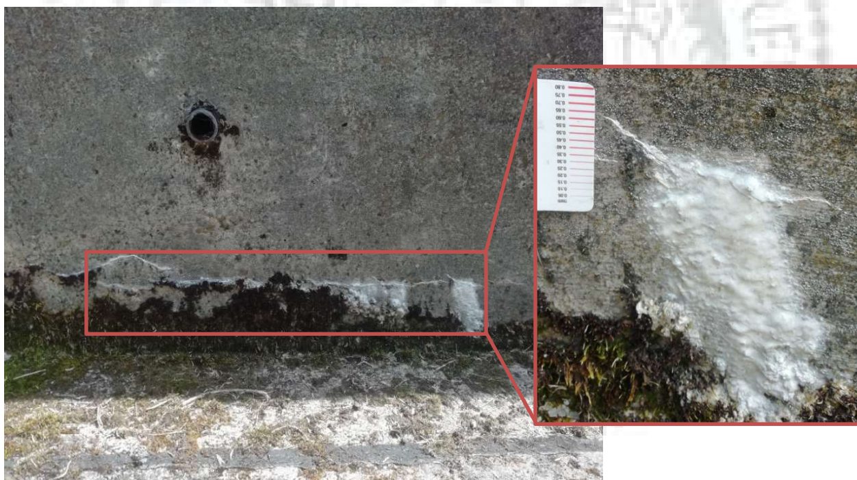
Fotografía. 89. Presencia de eflorescencias a través del muro lateral del canal. Fuente: Consorcio Embalses CAR, 2020.
