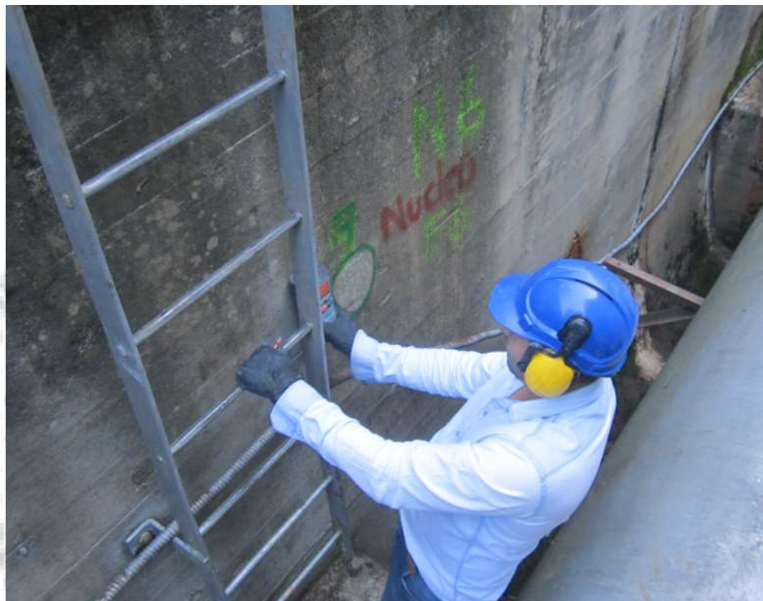
Fotografía. 104. Detección acero de refuerzo en muro del vertedero. Fuente: Consorcio Embalses CAR, 2020.
