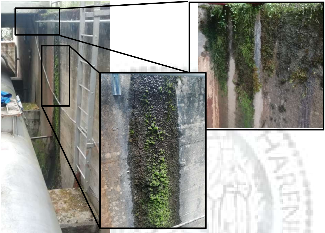
Fotografía. 77. Presencia de musgo y material orgánico.
