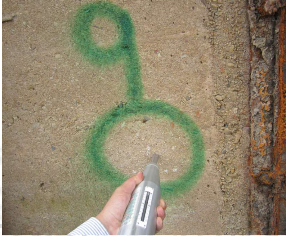
Fotografía. 105. Esclerometría en muro margen derecha canal de descarga. Fuente: Consorcio Embalses CAR, 2020.
