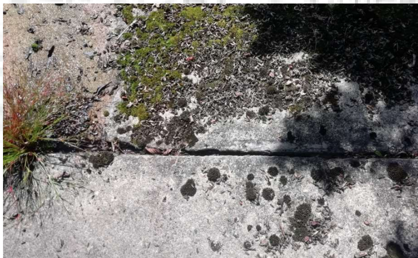
Fotografía. 86. Pérdida total del material de sello de la junta.
