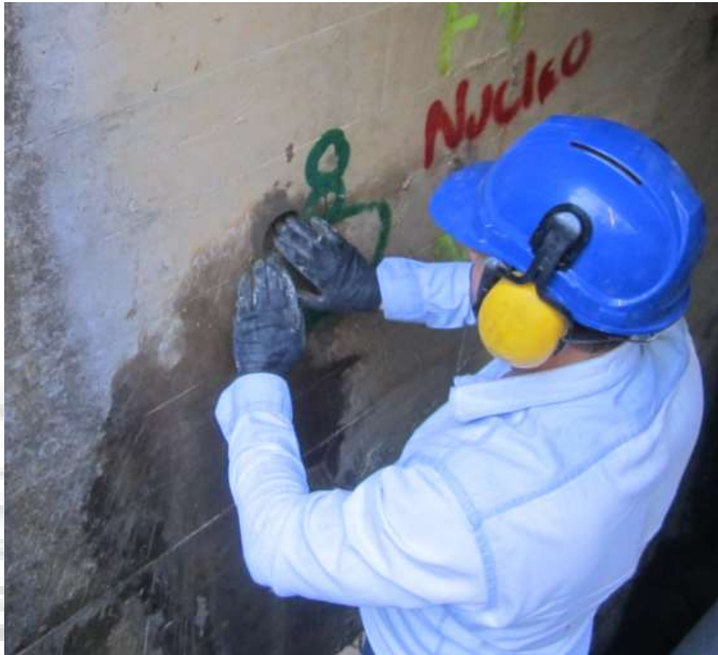
Fotografía. 103. Reparación típica de los núcleos extraídos.
