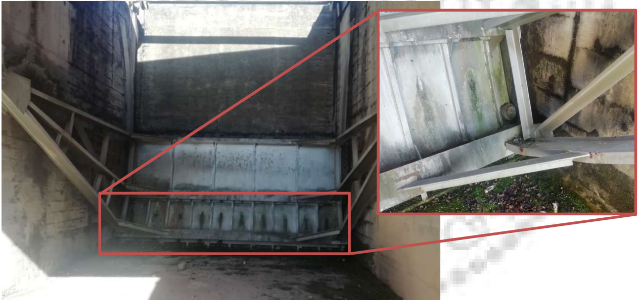
Fotografía. 81. Vista general compuerta colapsada (Aguas arriba). Fuente: Consorcio Embalses CAR, 2020.
