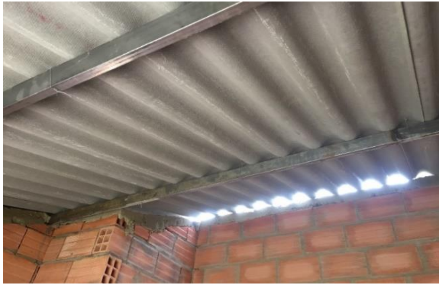
Imagen 49. Separación entre la cumbrera y la teja.
