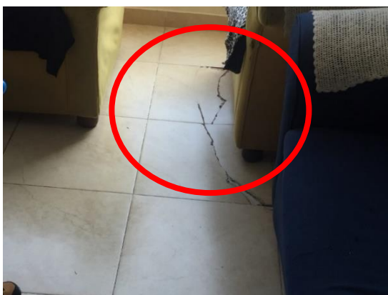
Imagen 66. Daños en pisos
