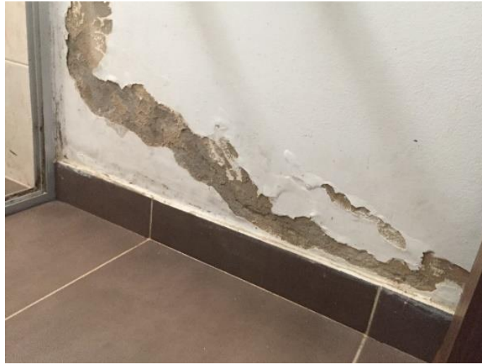
Imagen 63. Humedad en baños
