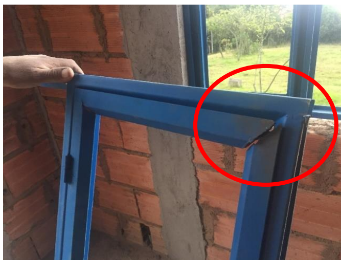
Imagen 59. Marco de ventana en mal estado.
