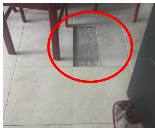
Imagen 67. Daños en pisos
