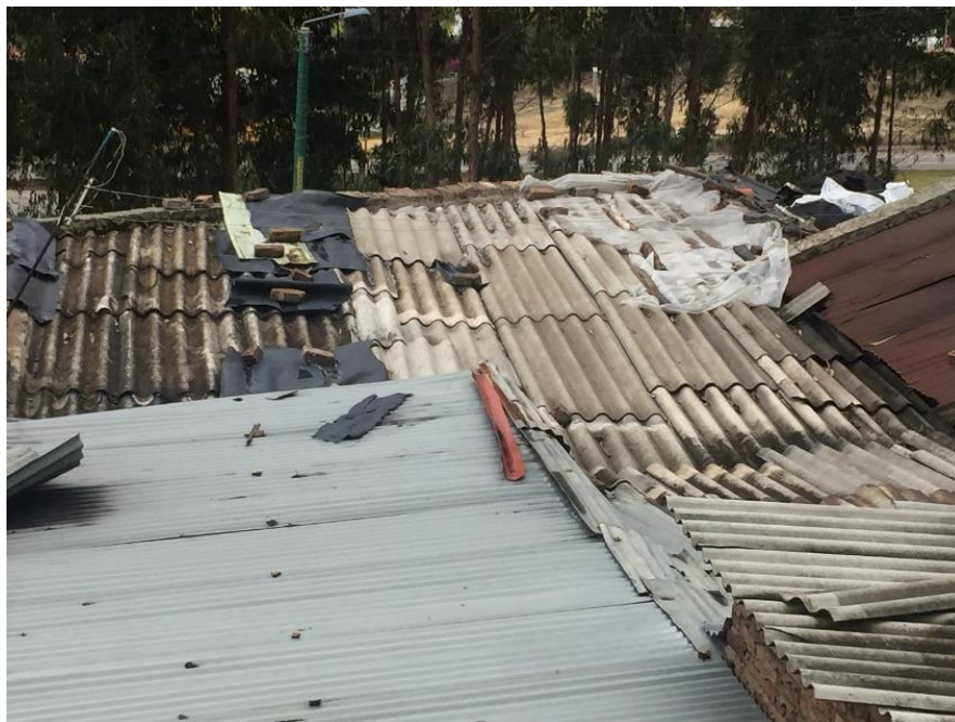
Imagen 84. Techo con tejas dañadas
