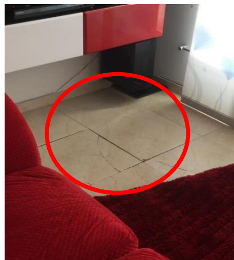
Imagen 69. Daños en pisos
