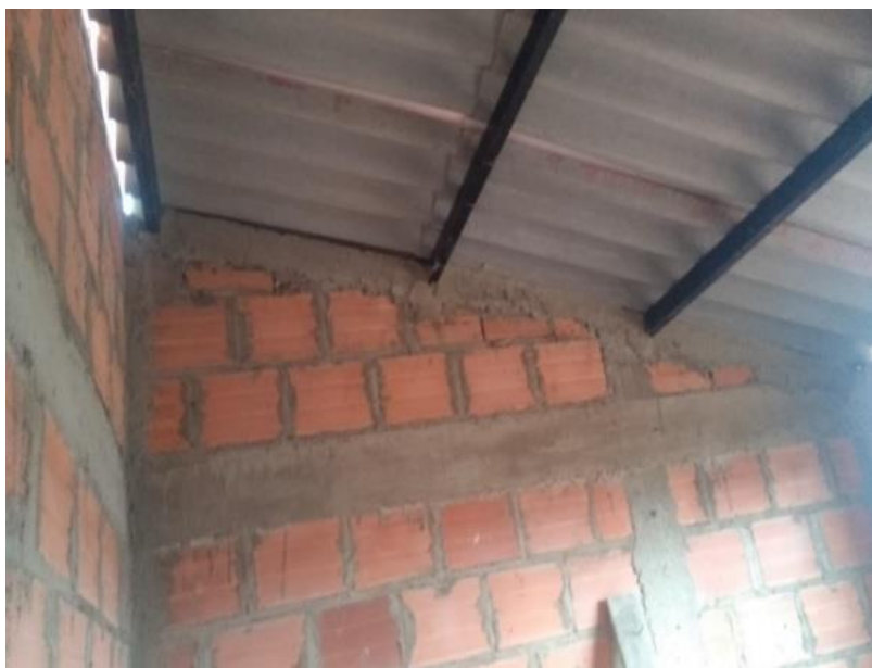
Imagen 48. Perfiles metálicos sin anticorrosivo.
