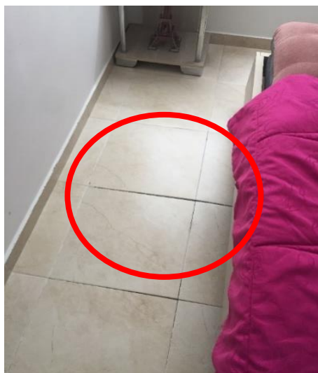
Imagen 68. Daños en pisos
