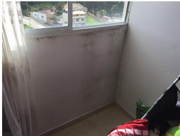
Imagen 64. Humedad en ventanas
