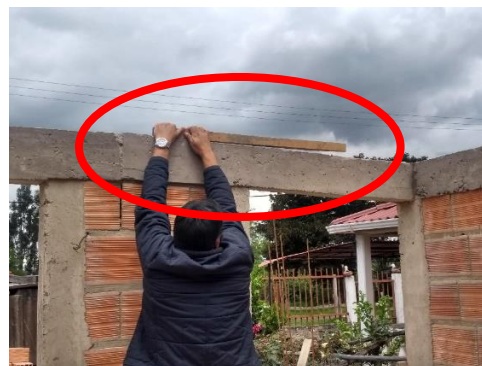
Imagen 42. Viga sobremuro desnivelada.
