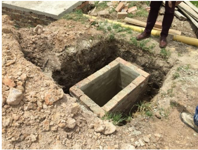
Imagen 53. Caja de inspección.
