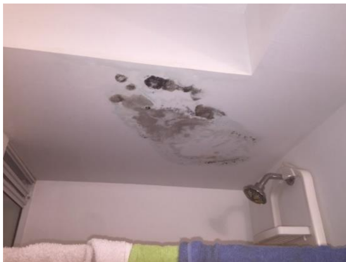
Imagen 65. Daños en buitrón.
