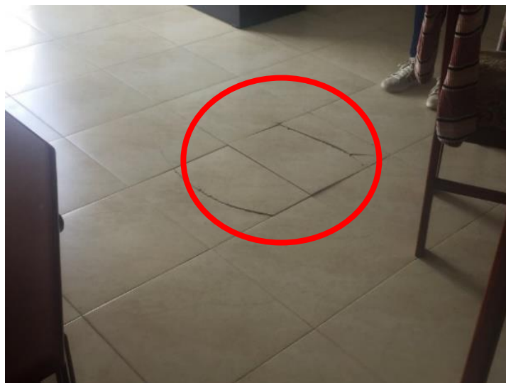
Imagen 70. Daño en pisos
