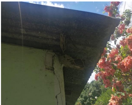
Figura 15; Deficiencia en la técnica constructiva.
