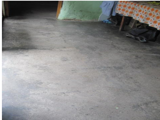
Figura 14; Estado del piso.
