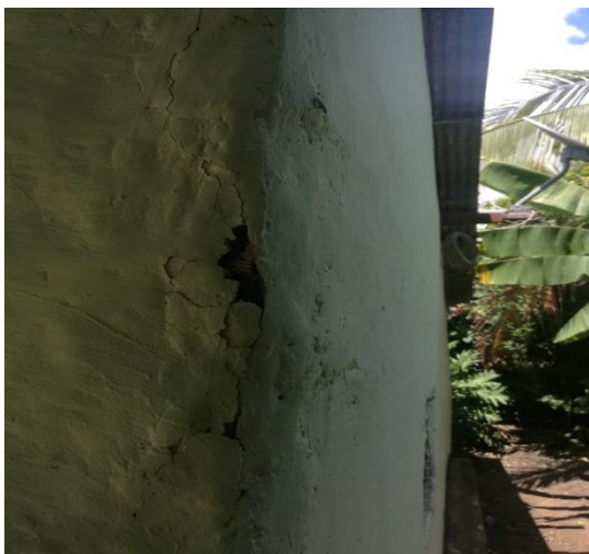
Figura 20; Cara externa en muro zona 1.
