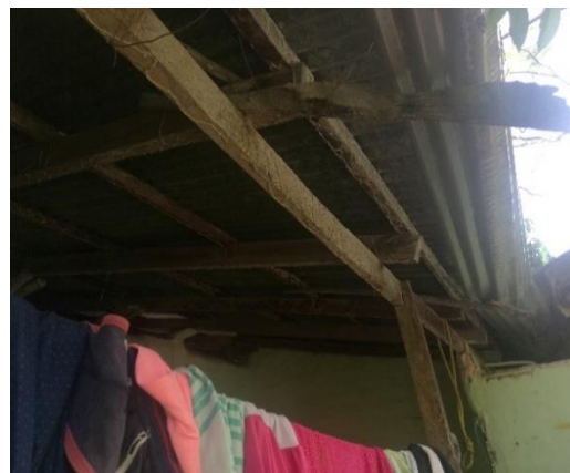
Figura 16; Estructura de cubierta en mal estado,
