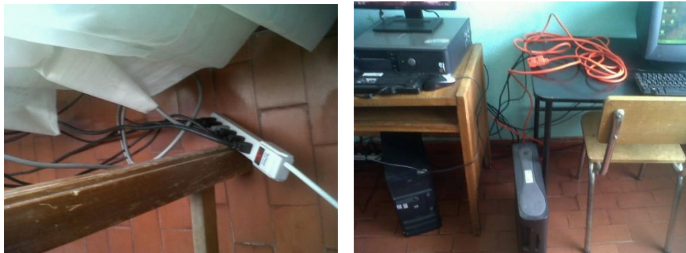
Fotografía 7. Riesgo evidente en la sala de sistemas.
