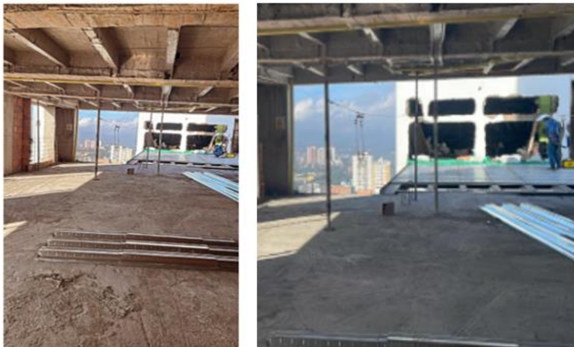
Figura 29. Obra central Park fase II, puente peatonal estado inicial de las pasantías.
