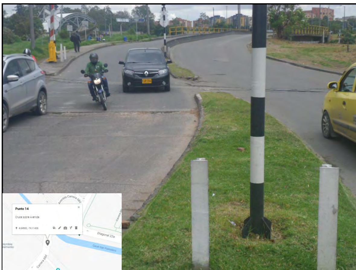
Ilustración 29. Malla vial deteriorada en el cruce de la línea férrea (Carrera 68D con Calle 22). Elaboración propia.
