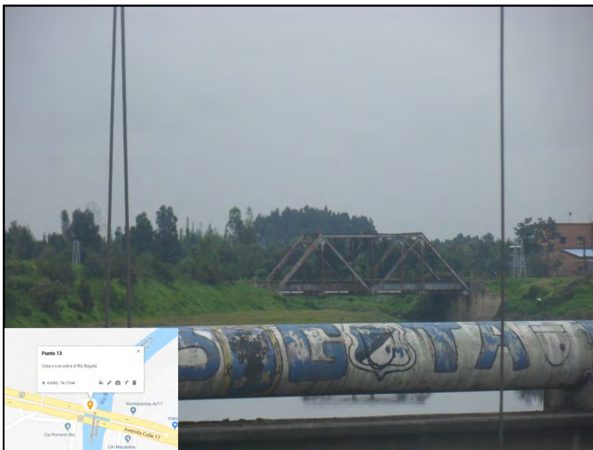
Ilustración 28. Zona del Rio Bogotá en evidente deterioro visible en la Calle 17 saliendo de Bogotá mirando hacia el cruce de la línea férrea sobre el río. Elaboración propia.
