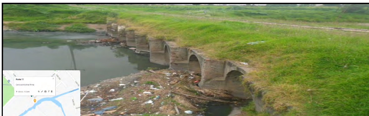
Ilustración 26. Zonas sin mantenimiento Tramo 2 Cerca al Parque Hayuelos (Calle 22 con Carrera 80A Bis). Elaboración propia.
