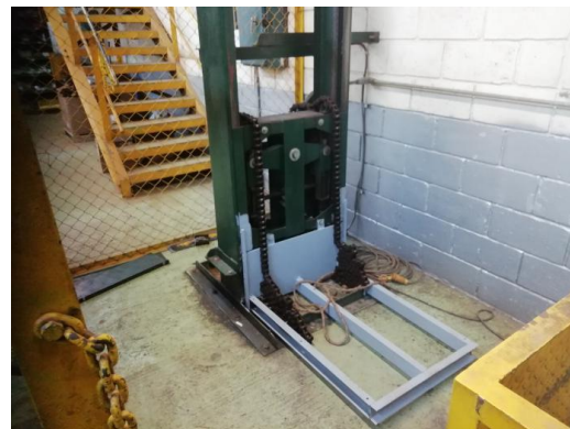
Imagen 6 modificación de la estructura y las uñas del elevador
