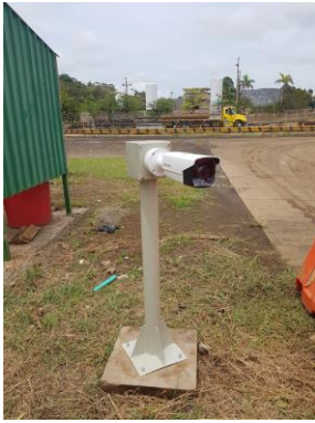
Imagen 11 cámara de reconocimiento de placa
