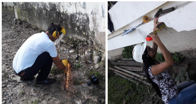
Figura 7. Extracción del acero para toma de muestras, fuente Rocha, L. Ruiz, D (2018)
