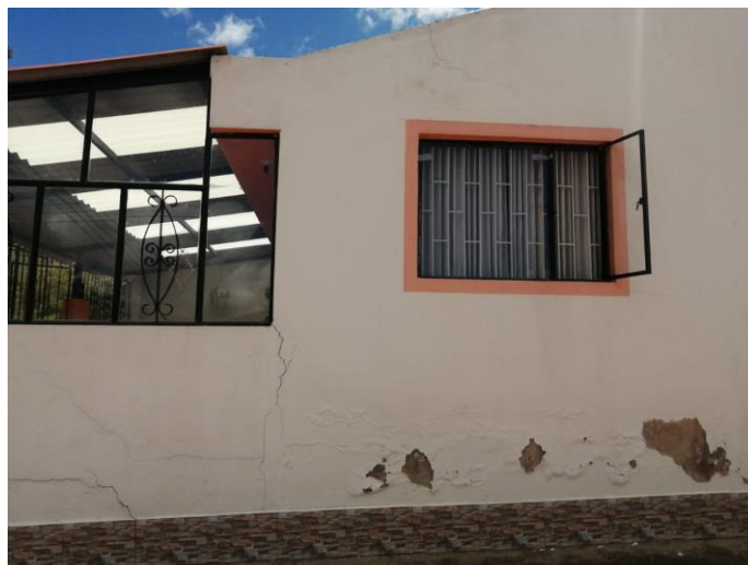
Imagen 16. Vivienda con problemas estructurales en el Barrio Sauzalín.
