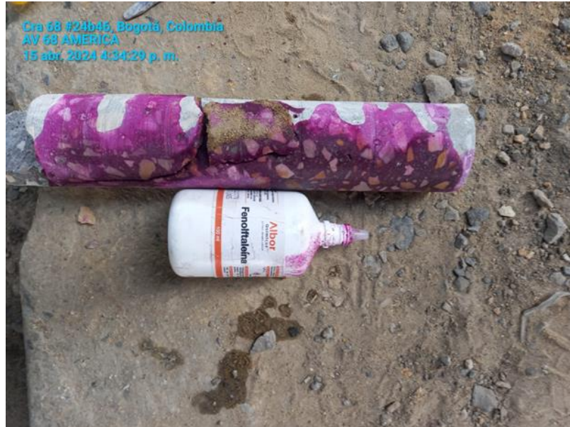
Figura 64: Carbonatación Núcleo Columna 4 – Eje 5, Costado Sur
