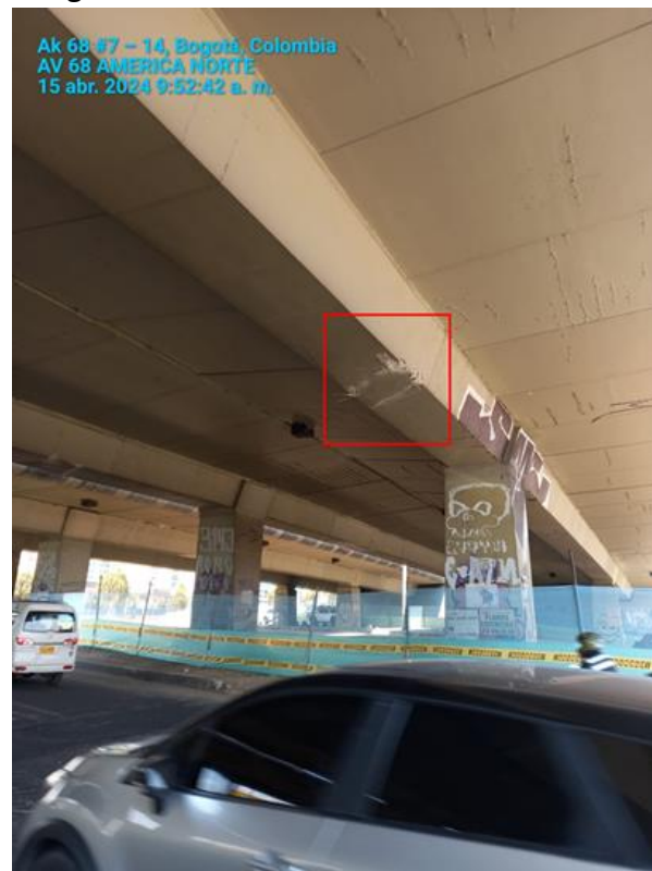
Figura 34: Pérdida de fibras de carbono
