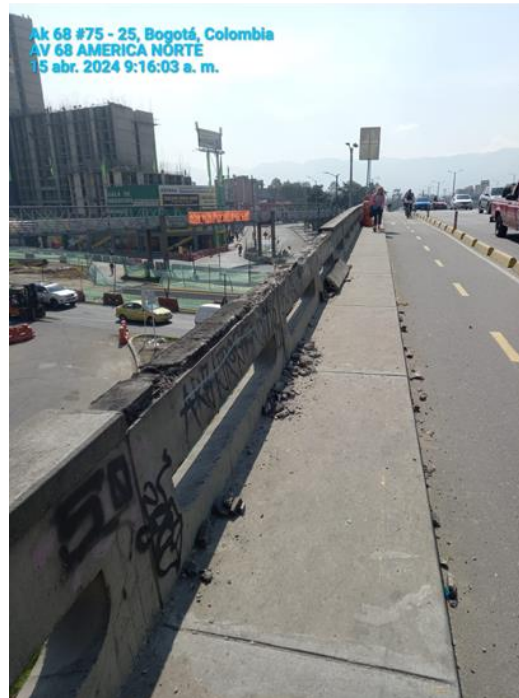
Figura 31: Desprendimiento de corta goteras por impacto vial
