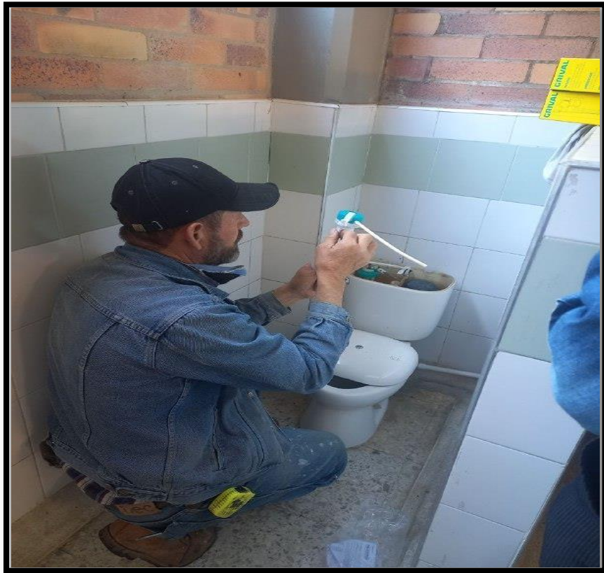
Imagen 39. Cambio de grifería en los baños de C.D.I.S en el Barrio Cerros de la Alameda
