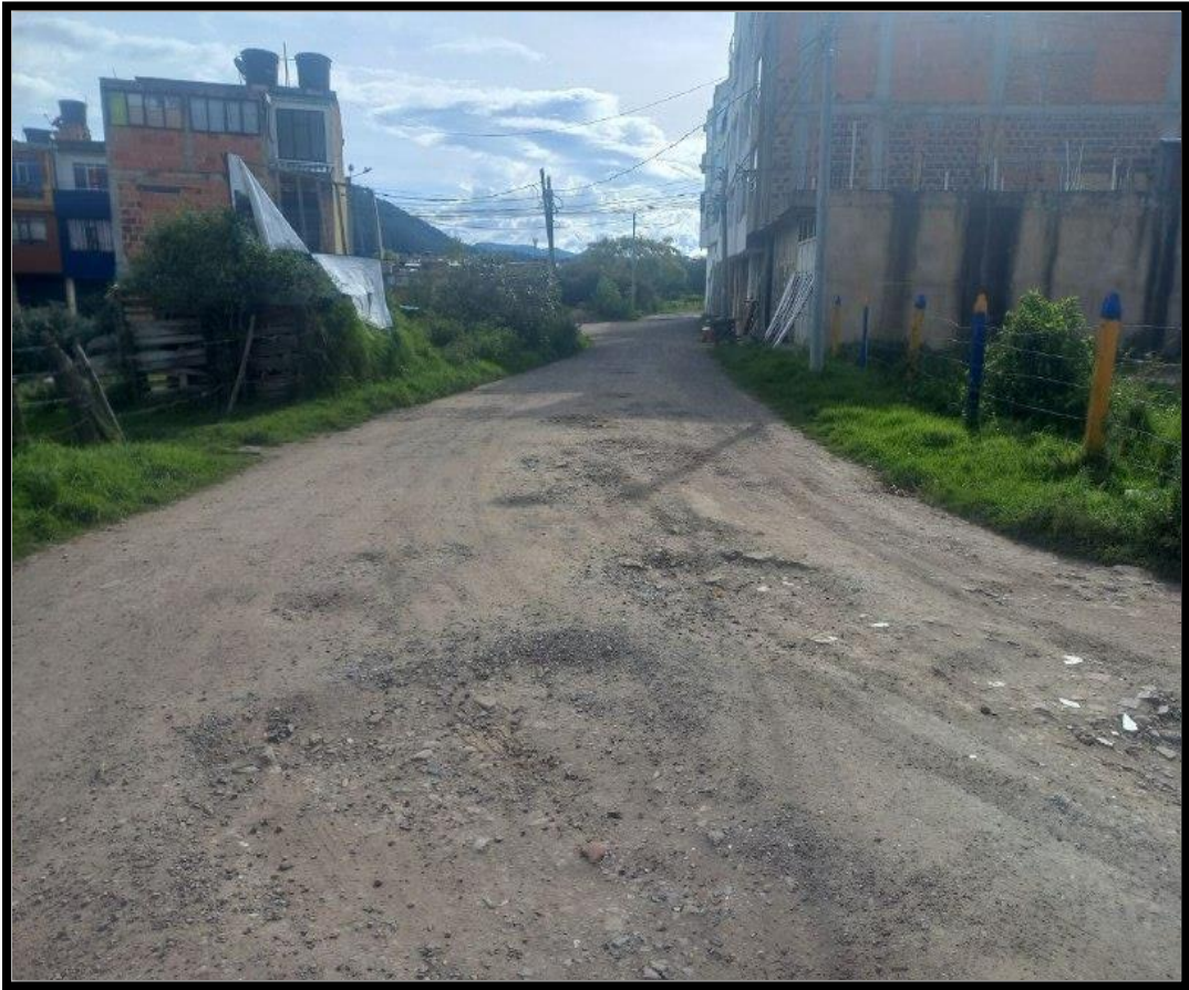
Imagen (24). ESTADO DE LA VIA
