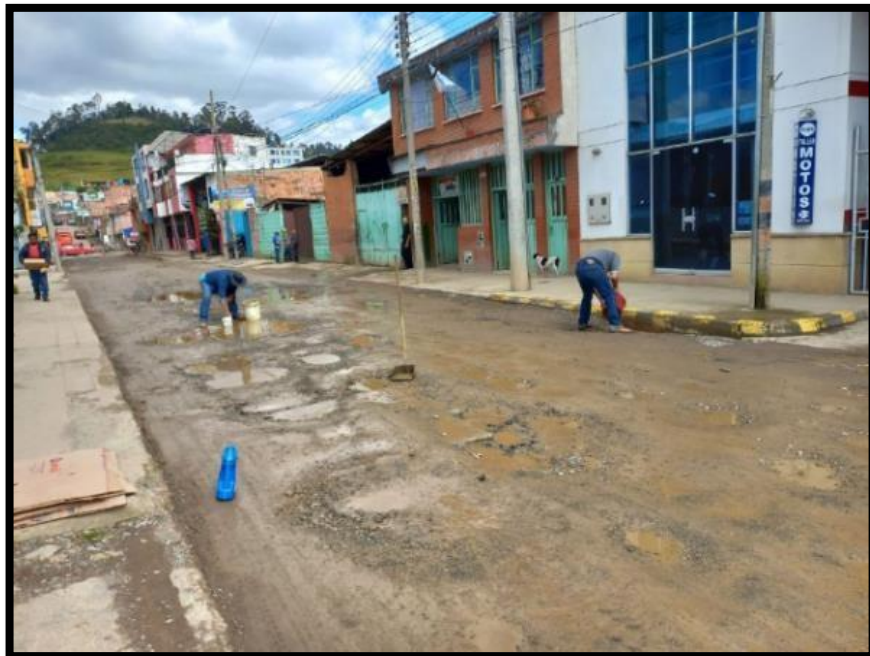
Imagen (14) Estado de la vía (asfalto y lodo)
