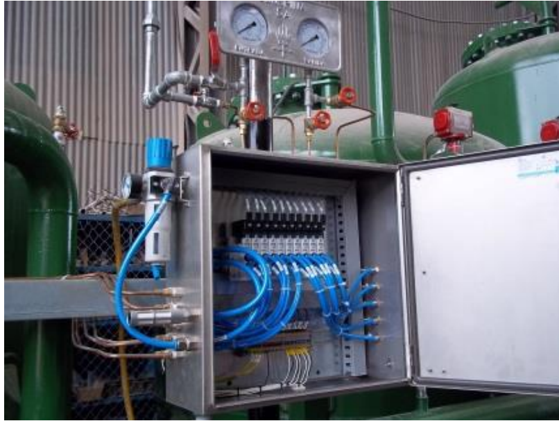
Figura. 22 Tablero de distribución neumática para las electroválvulas. Fuente: Autor.
