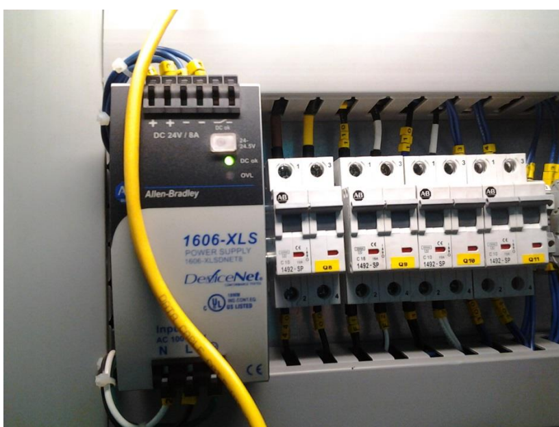
Figura. 17 Fuente de Alimentación PLC, 24 Vdc. Fuente: Autor.
