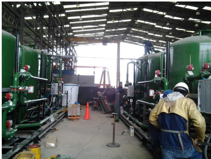
Figura. 14 Vista general de los dos skids de tratamiento. Fuente: Autor.
