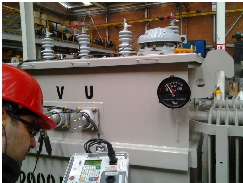
Figura. 10 Medición de resistencia entre terminales. Fuente: Autor.
