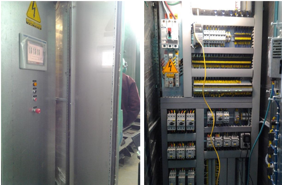
Figura. 15 Tablero de Distribución y Control. Fuente: Autor.
