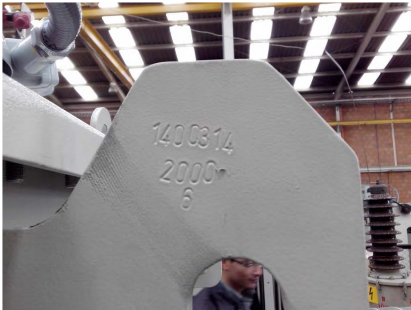
Figura. 2 Identificación del serial del transformador. Fuente: Autor
