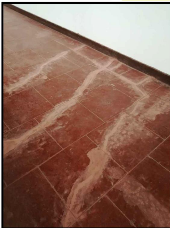
Figura 11. Fisuras en pisos.
