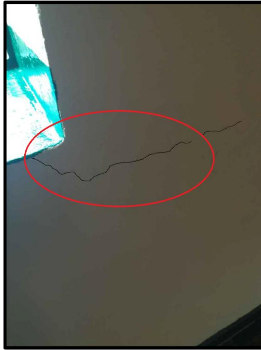
Figura 12. Fisuras en muros.
