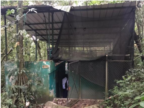
Figura 2. Planta de tratamiento de agua potable compacta
