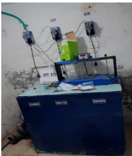
Figura 10. Estado de bombas y tanque dosificador
