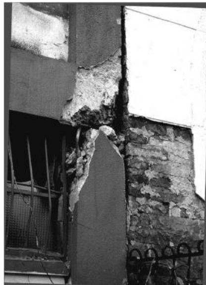
Ilustración 6.3. Falla a cortante en las columnas [9]
