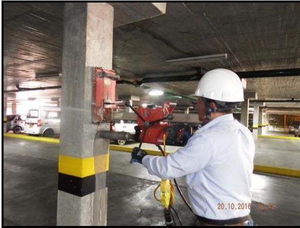
Figura 43. Extracción de Núcleo Perpendicular al Plano de Colocación del Concreto. Columna en Sótano Sector de Mayor Resistencia.
