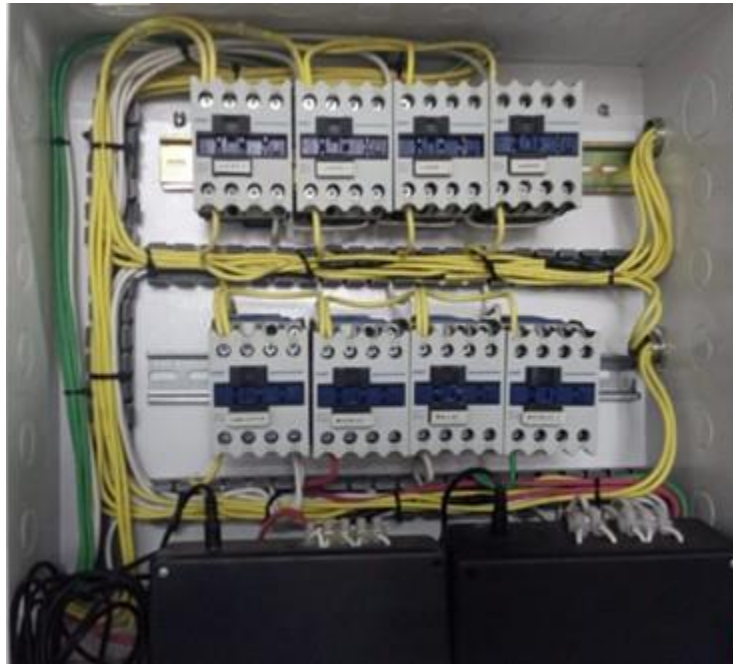
Figura 4. Distribución posterior del tablero de automatización.
