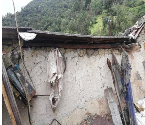
Figura 12. Estado de vivienda.
