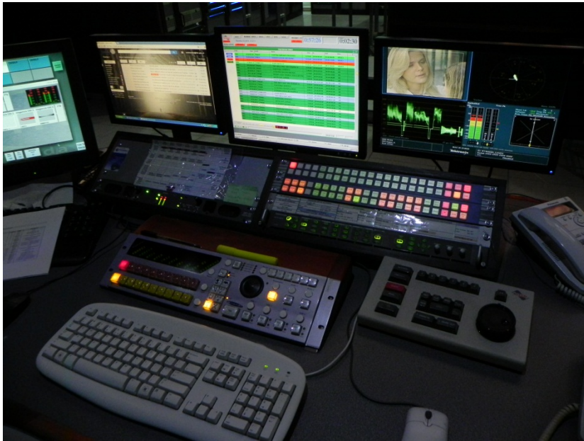
Figura 87. Equipos de consola para operación y supervisión.
