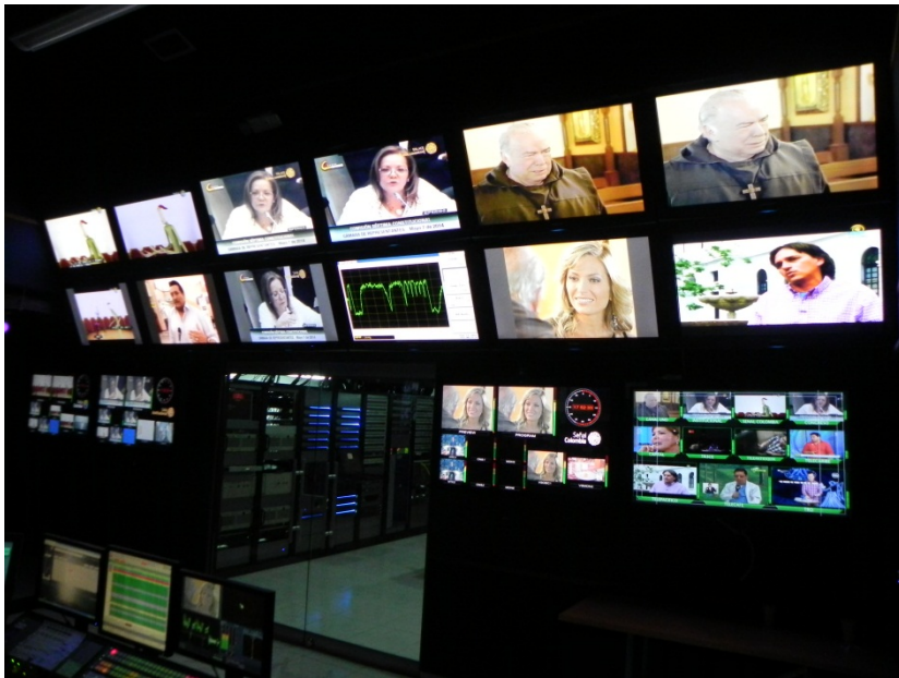
Figura 88. Pantallas de monitoreo de Señal Colombia, Señal Institucional y Canal UNO.
