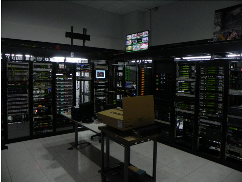
Figura 4. Master de Emisión Salón de Equipos.
