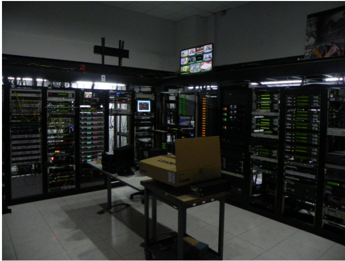
Figura 7. Sala de equipos.
