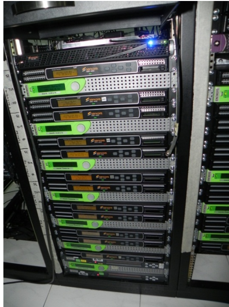
Figura 9. Rack de equipos.
