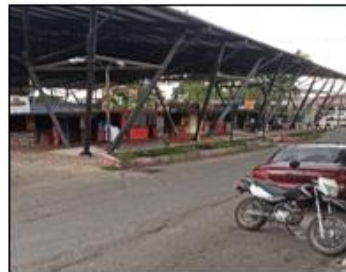
Fotografía 3 (Estado de la vía - Calle 10, Fuente: Autor).
