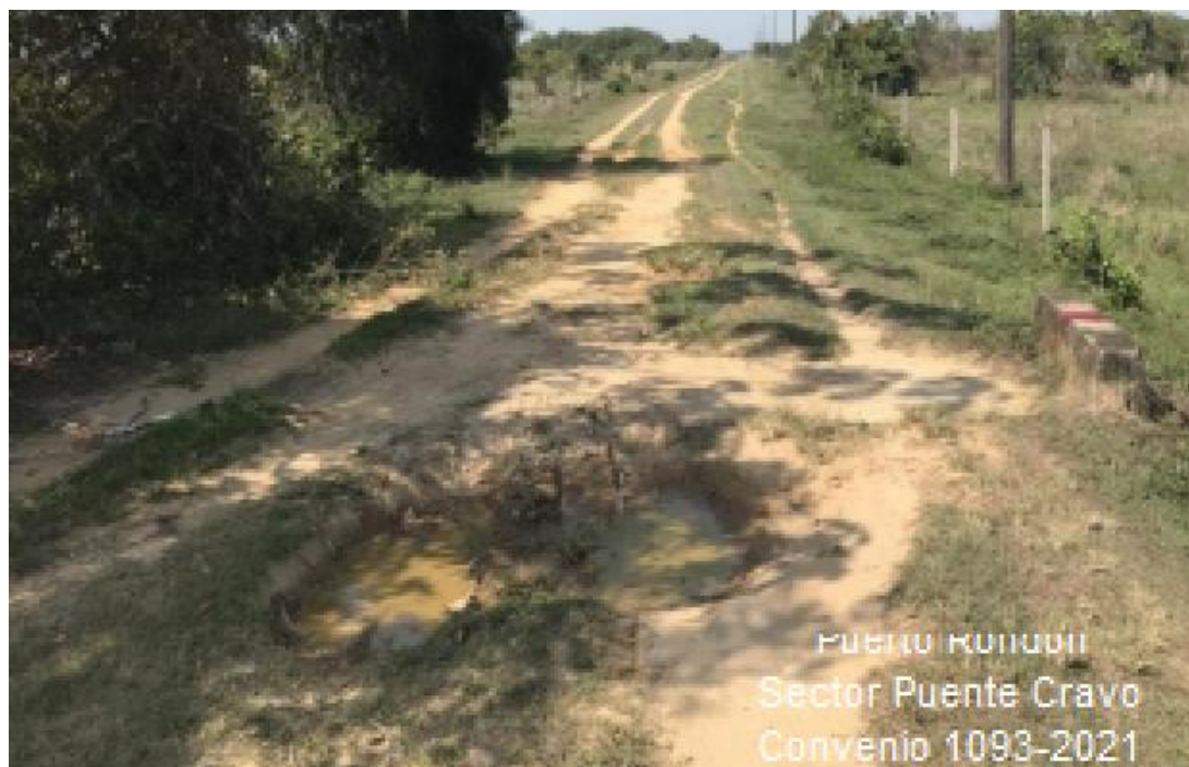
Figura 6. Estado inicial de la vía a intervenir, Puerto Rondón
