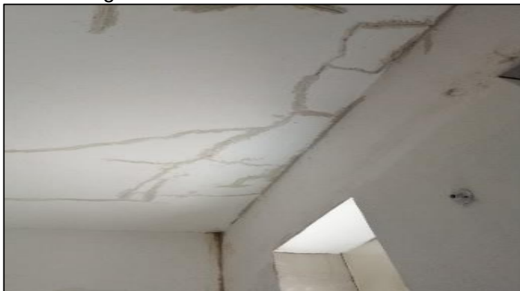
Figura 8. Techos resanados del local
