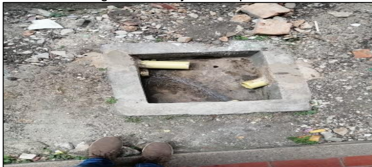
Figura 19. Caja de inspección
