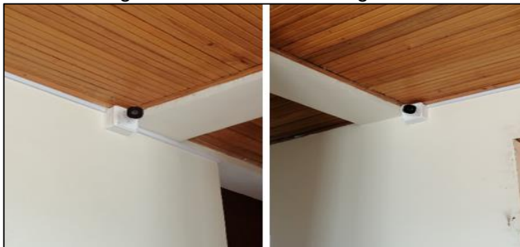
Figura 15. Cámaras de seguridad
