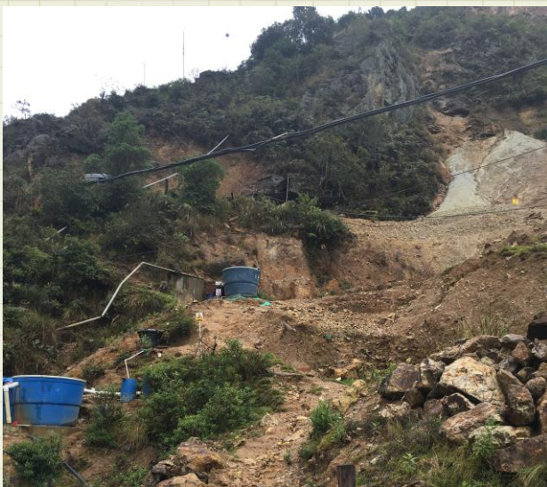
En la fotografía se observa, el montaje total de la planta de tratamiento de aguas de mina.
