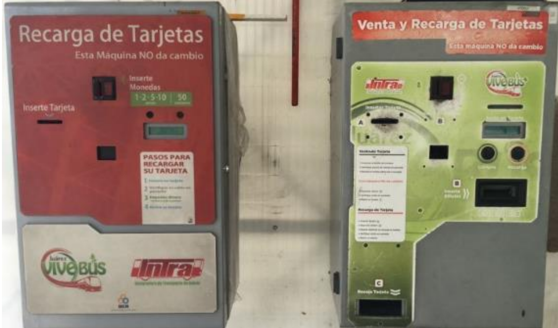
Figura 71. Máquinas de venta y recarga de tarjetas.
