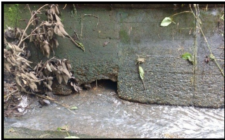
Figura 45. Filtraciones del alcantarillado a Q. Carbonera
