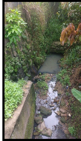
Figura 43. Filtración de agua residual
