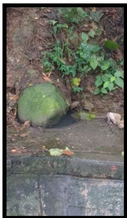
Figura 47. Falta de mantenimiento cajas de inspección
