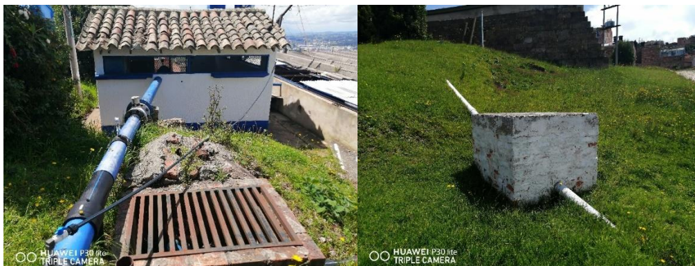
Figura 9. Ubicación de macromedidores en entrada y salida de Tanque El Carmen. Nota: elaboración propia
