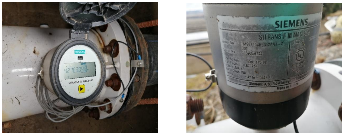
Figura 13. Caudalímetro marca Siemens instalado en la sede. Nota: elaboración propia
