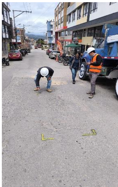
Fig. 3 . Demarcación del área afectada de acuerdo con el diagnóstico visual.
