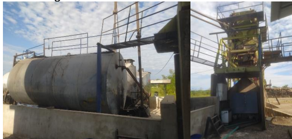
Figura 2. Planta de asfalto PASOLIN
