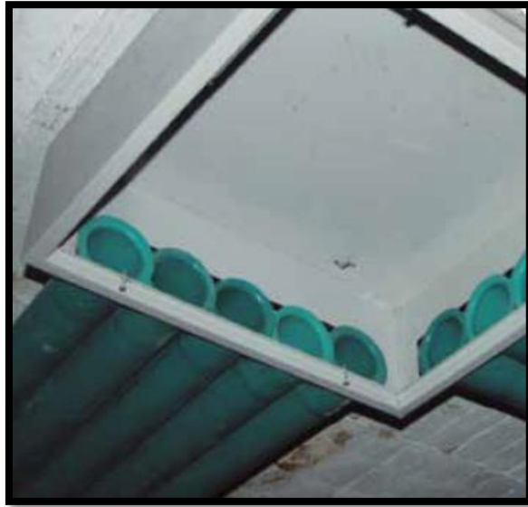
Figura 18. Caja de paso para tubería eléctrica
