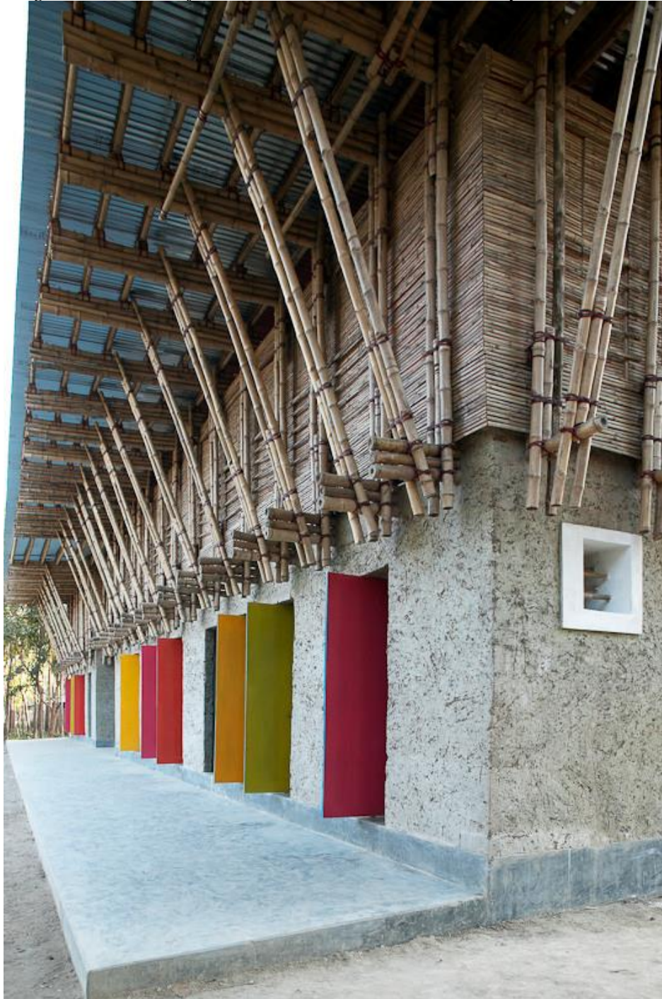
Figura 23. Imagen detalle de la junta entre la estructura en bambú y los muros de tierra
