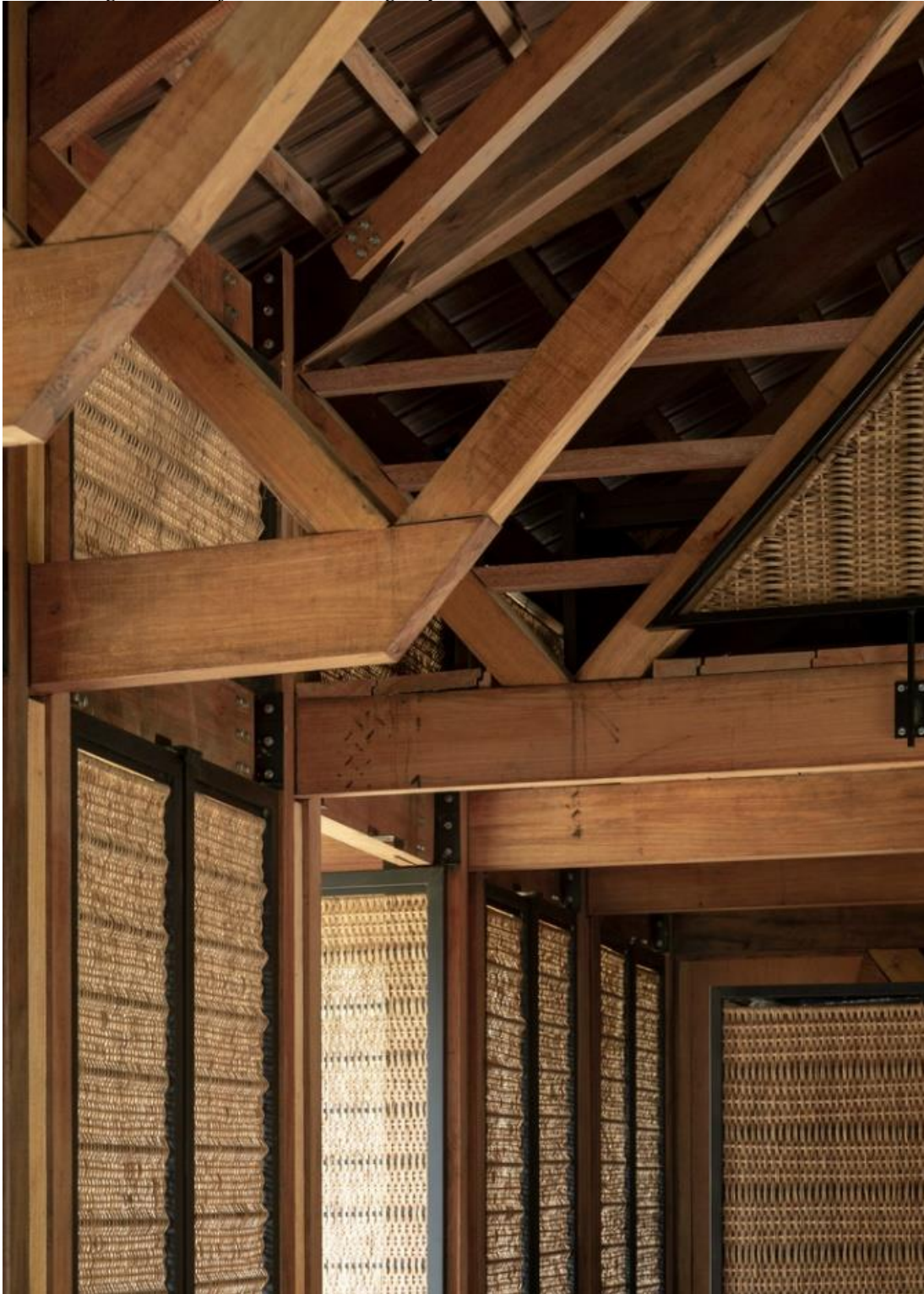
Figura 20. Imagen de las juntas de las vigas y columnas
